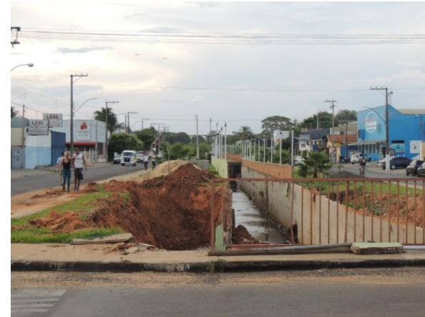
Figura 30 – Pontos de desmoronamento da canalização. Fonte: Arquivo pessoal.
