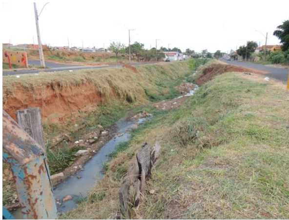
Figura 33 – Situação dos trechos sem canalização no Córrego do Cardoso. Fonte: Arquivo pessoal.
