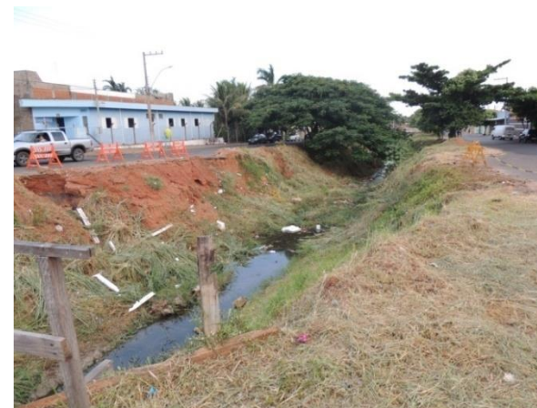
Figura 37 – Local interditado por queda da ponte de automóveis. Fonte: Arquivo Pessoal.
