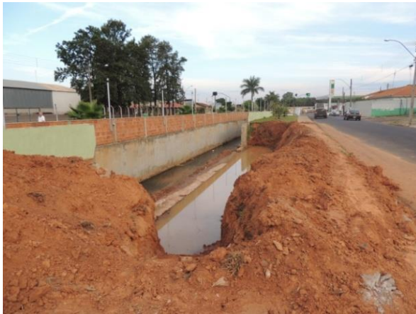
Figura 29 – Pontos de desmoronamento da canalização. Fonte: Arquivo pessoal.
