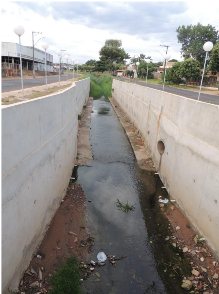
Figura 31 – Ponto de interrupção da canalização do Córrego do Cardoso. Fonte: Arquivo pessoal.
