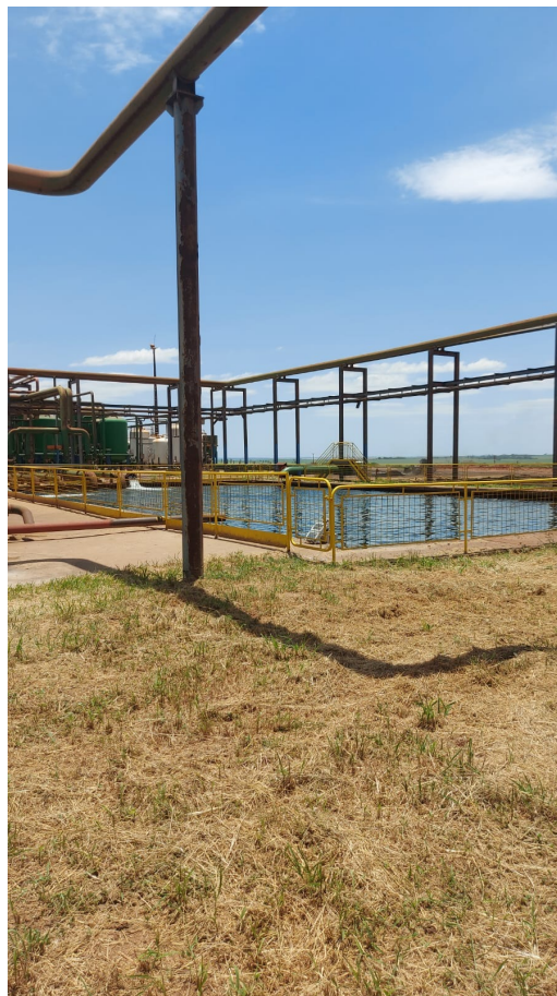
Figura 28 – Tanque Pulmão do Bioparque Raízen Energia Unidade – GASA.
