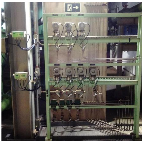
Figura 68 – Exemplo de “Rack” dos pressostatos.
