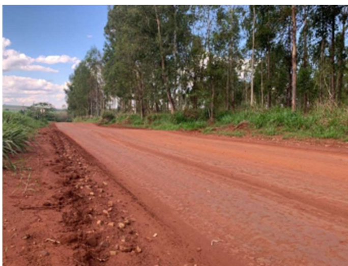
Figura 30 – Segregação de agregados Estrada 1
