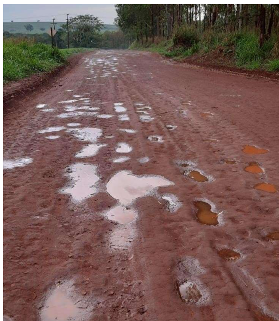
Figura 3 –Seção transversal inadequada
