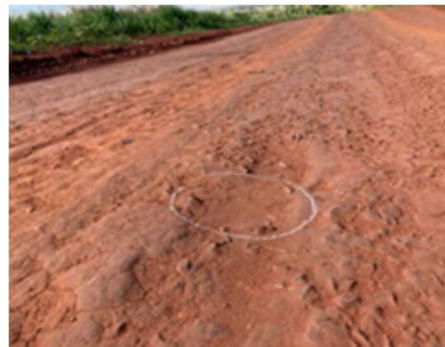
Figura 26 – Buracos na Estrada 2
