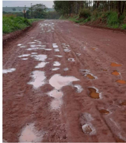
Figura 25 – Buracos na Estrada 1
