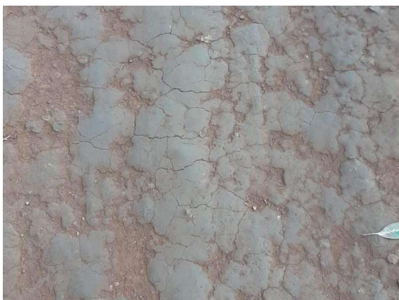
Figura 33 – Trincas de retração na Estrada 1
