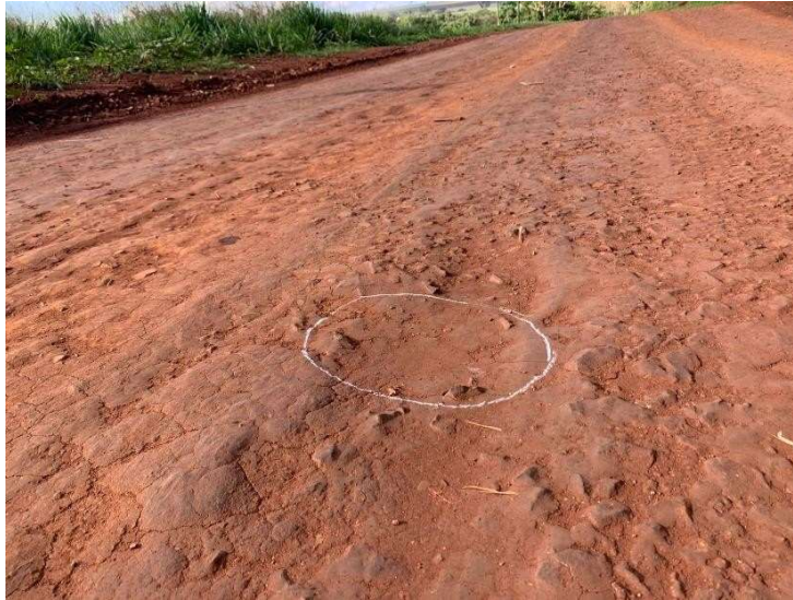
Figura 17 – Utilização do giz para melhor entendimento do defeito
