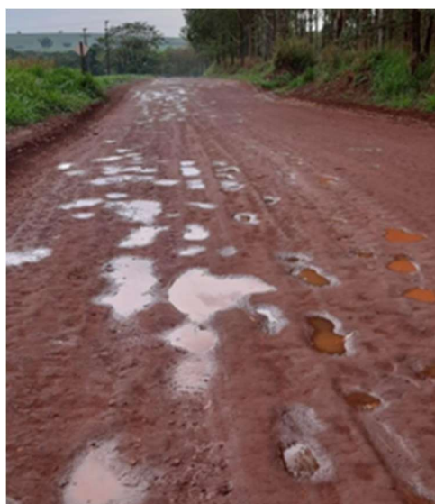
Figura 34 – Poças d’água no Trecho 2 da Estrada 1
