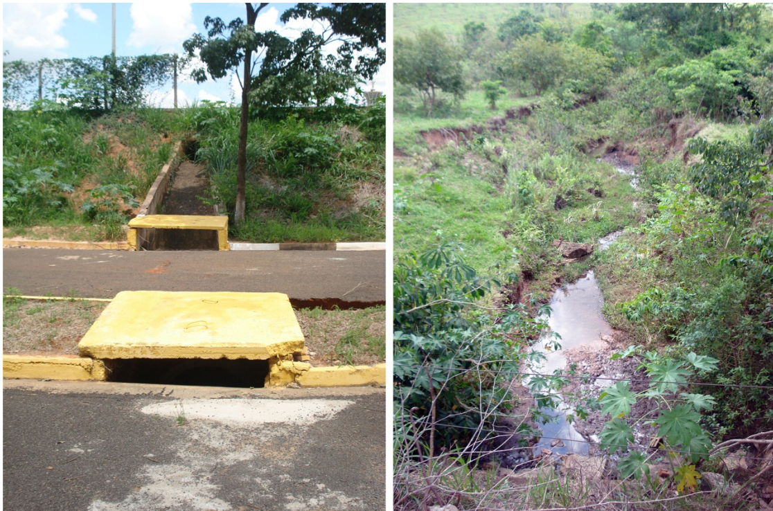
Figura 12 – Drenagem do Estacionamento do Santuário Madre de Deus que desemboca diretamente no córrego do outro lado da estrada provocando grave erosão.
