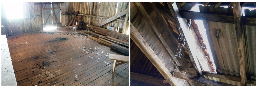
Figura 24 – Piso sujo com fezes de pássaros e parte danificada da cobertura do guenkan(varanda) da Escola Japonesa. Fonte: Arquivo Pessoal, 2013.
