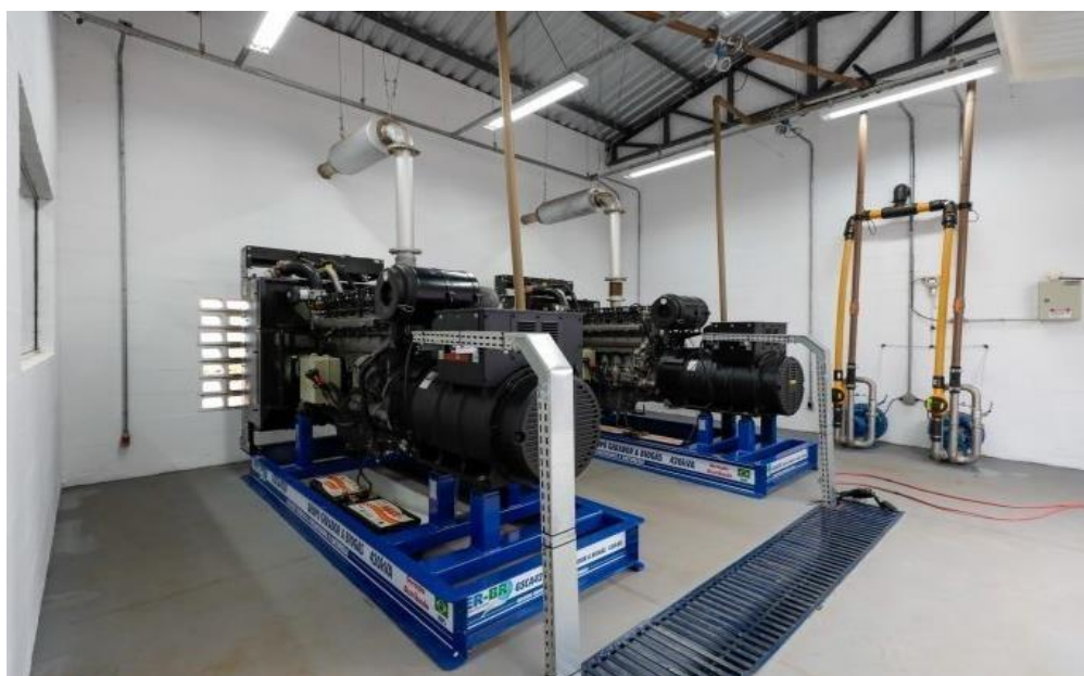
Figura 14 – Geradores da Mini Central Termelétrica alimentados com o biogás rico em metano.
