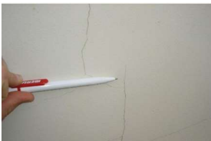
Figura 1.1 – Microfissura em revestimento em argamassa
