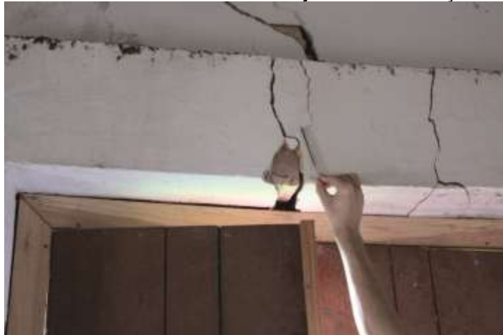
Figura 1.3 – Trincas, rachaduras e junta em vedação vertical
