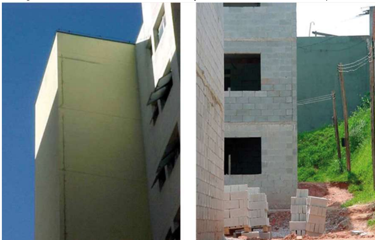
Figura 4.7 – Fissuras verticais e amarração indireta em alvenaria autoportante
