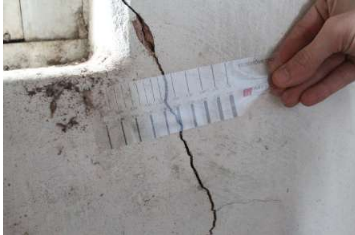
Figura 1.2 – Fissura em abertura
