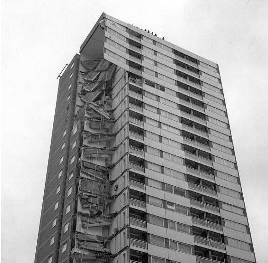
Figura 2.11 – Colapso progressivo no edifício Ronan Point (Londres)
