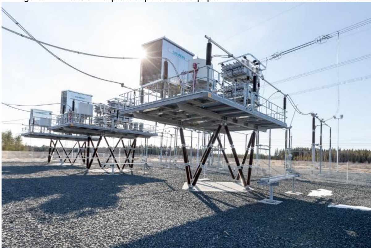
Figura 7 - Plataforma para suporte dos equipamentos de uma fase de um FSC
