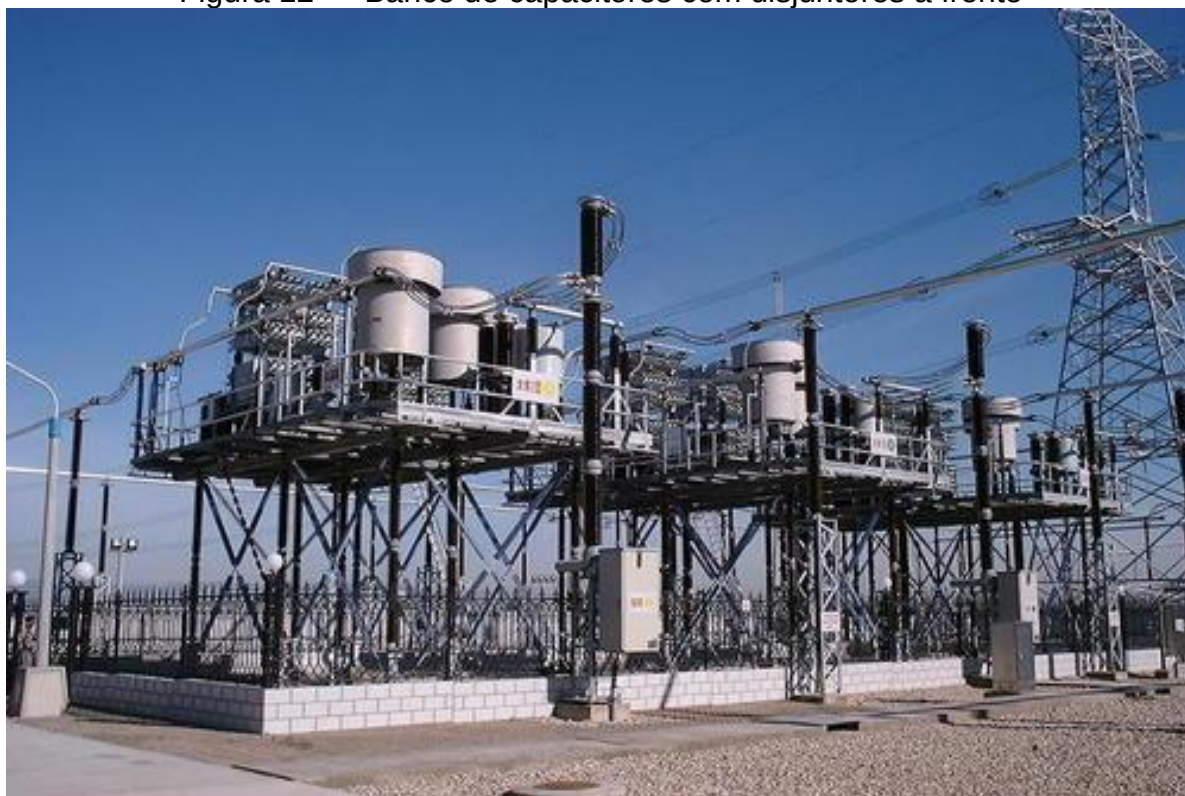
Figura 12 — Banco de capacitores com disjuntores à frente
