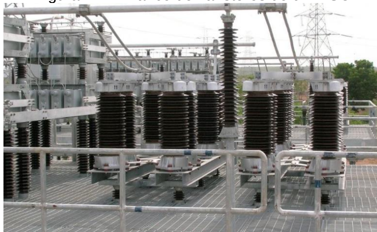
Figura 11 — Banco de varistores de um FSC
