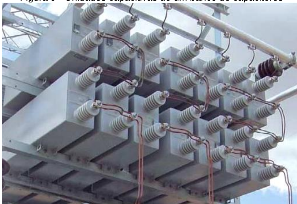
Figura 9 - Unidades capacitivas de um banco de capacitores
