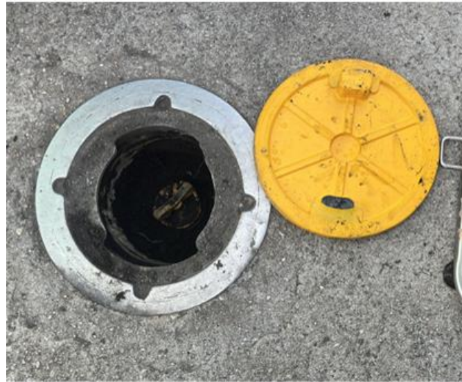
Figura 18 - Tampa de abertura de poço de monitoramento instalado
