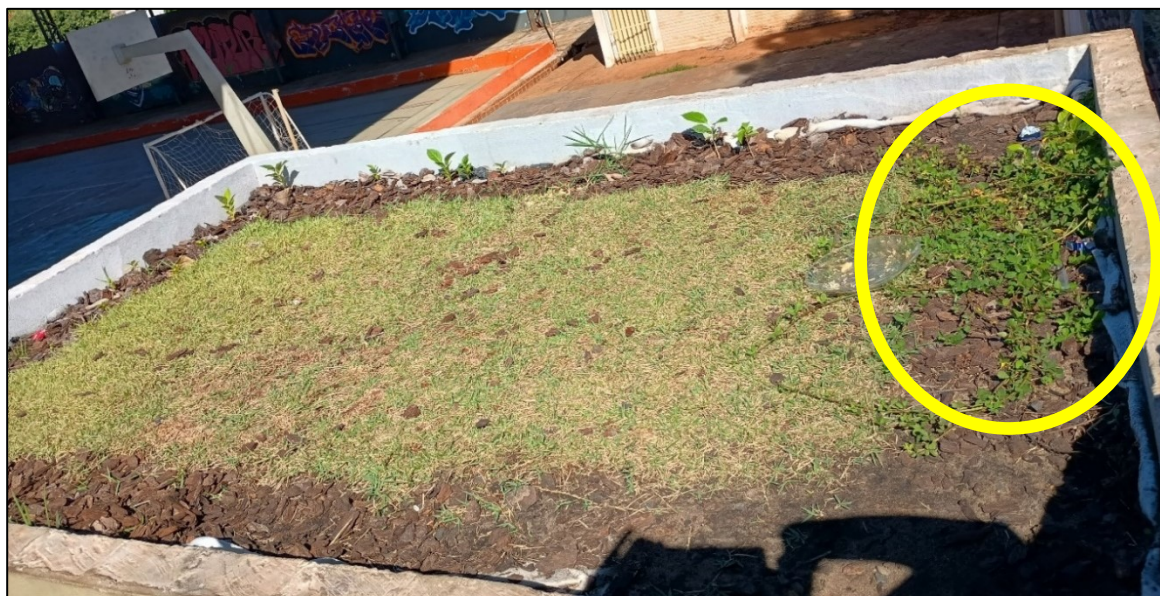
Figura 25. Telhado verde após a falta de manutenção
