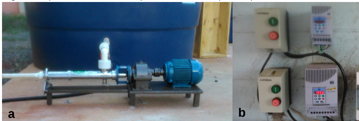
Figura 7- a) Bomba dosadora e b) Inversores de frequência para controle de vazão
