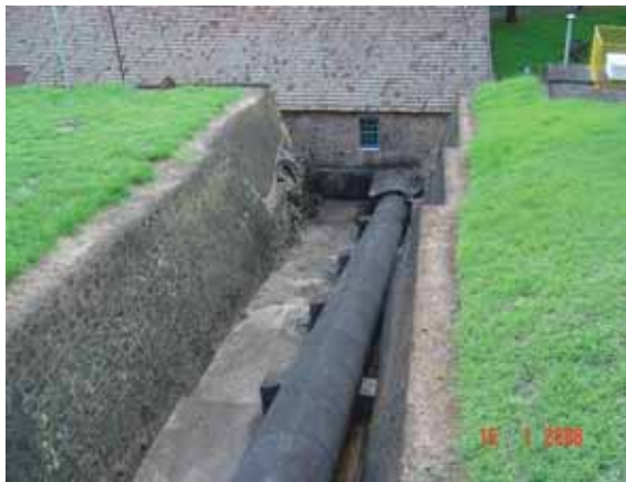
Foto 8 Tubulação da Caixa de Compensação (Diferença de energia potencial gravitacional)
