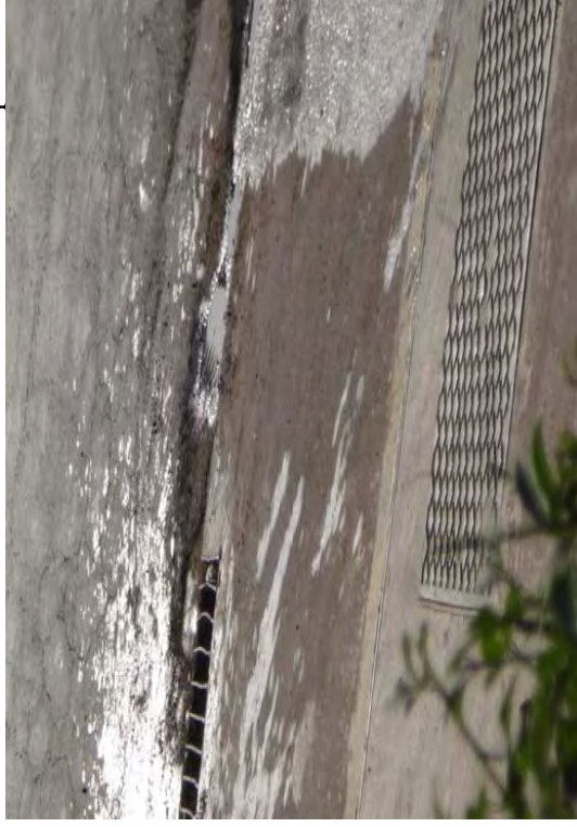
Foto 4: Água da área de lavagem sendo direcionada diretamente à boca de lobo.
