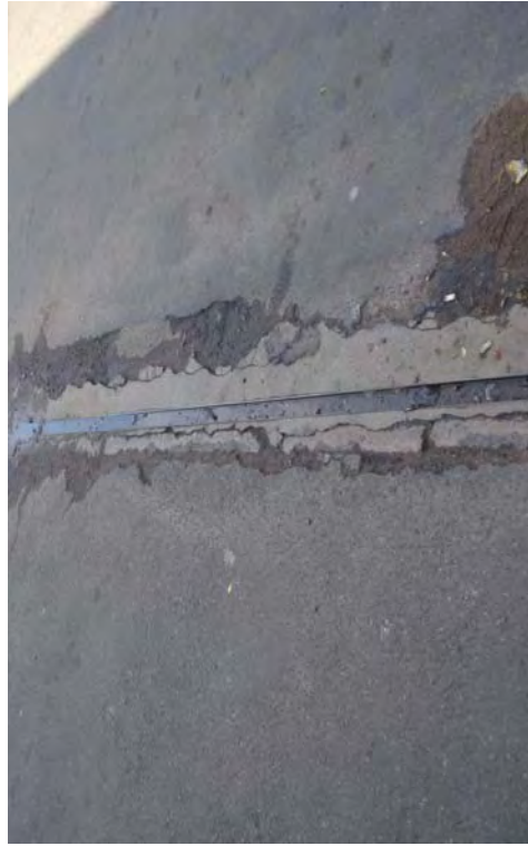
Foto 2: Canaleta não suporta o fluxo de água da área de abastecimento. Notar trincas que permitem infiltração de combustíveis vazados na superfície.
