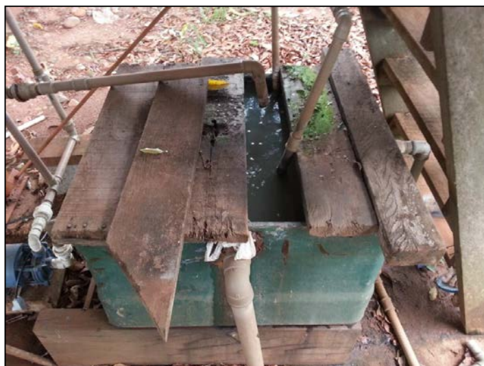
Figura 17- Tanque de equalização
