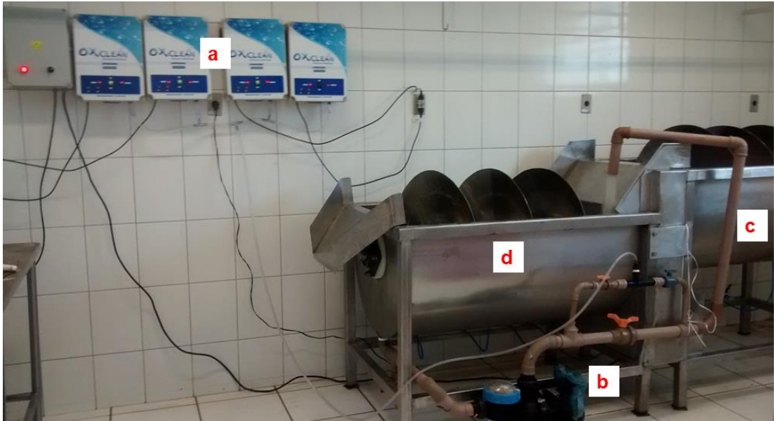
FIGURA 1 – a) geradores de ozônio; b) bomba d'água; c) primeiro estágio do “chiller”; d) segundo estágio do “chiller”.
