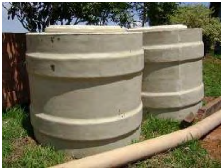
Figura 7: Fotografia dos dois reservatórios de 3.000 l
