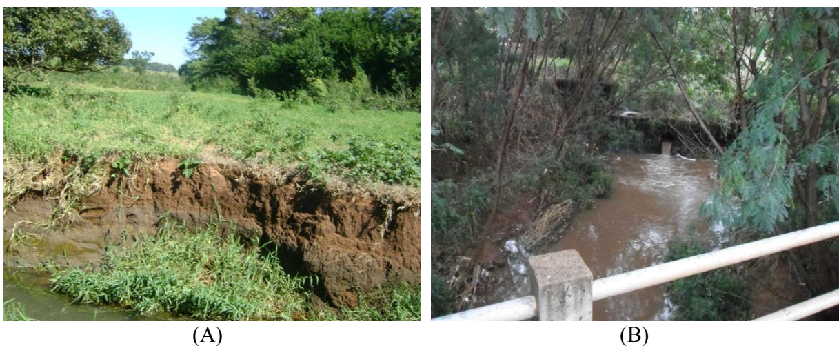
Figura 37 – Processos de degradação: Processos erosivos (A); Lançamento da drenagem urbana (B)
