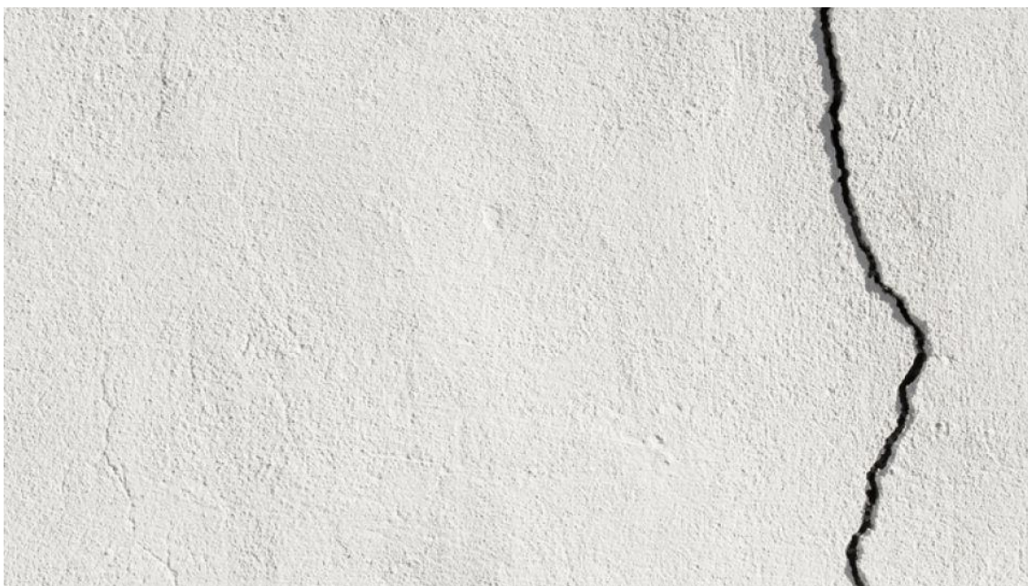
Figura 2 - Trinca em Parede de Alvenaria.
