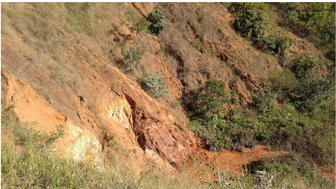
Figura 39 - Paredes instáveis da Feição 2.
