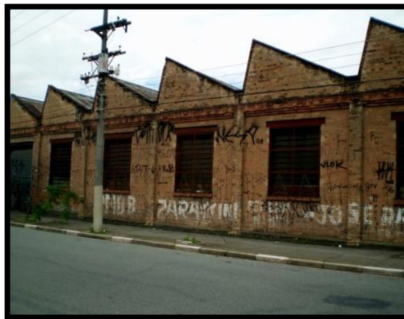
Foto 56: Depósitos parcialmente utilizados, em estado de abandono, na Mooca Foto da autora (2011)
