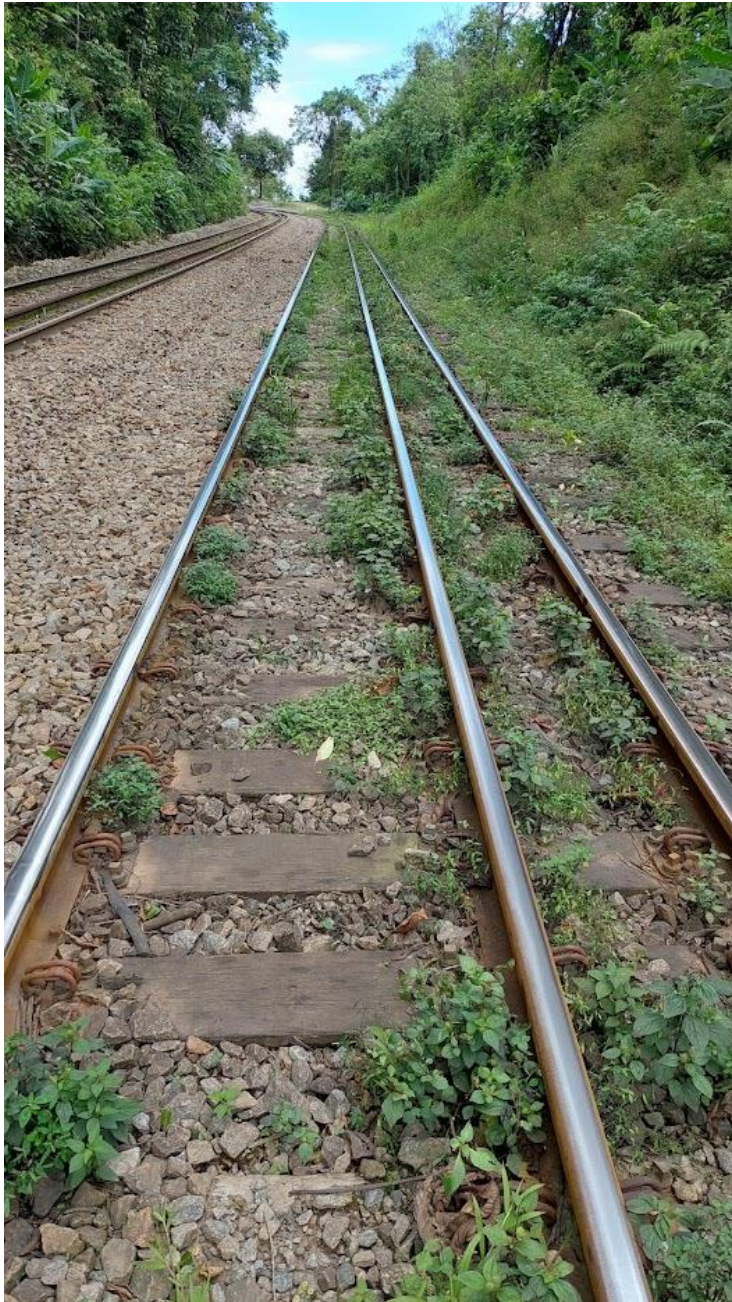
Figura 24. Ponto de coleta Gaspar, áreas com trânsito de pessoas no momento da aplicação – área não aplicada (Botucatu, 2022)
