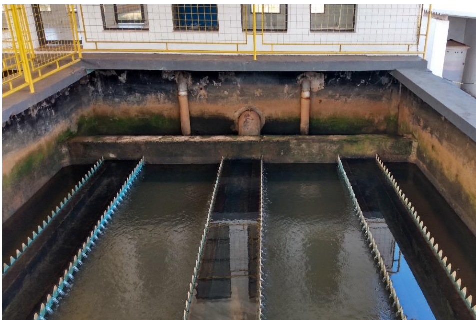
Figura 20 – Um dos quatro filtros da ETA visto de frente
