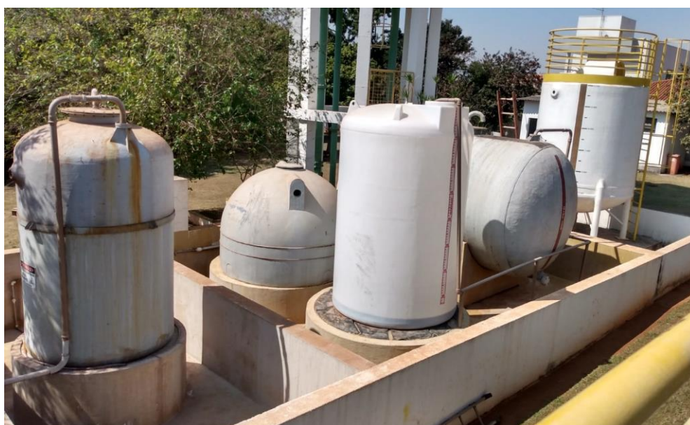
Figura 09 – Reservatórios de sulfato de alumínio e ácido fluossilícico
