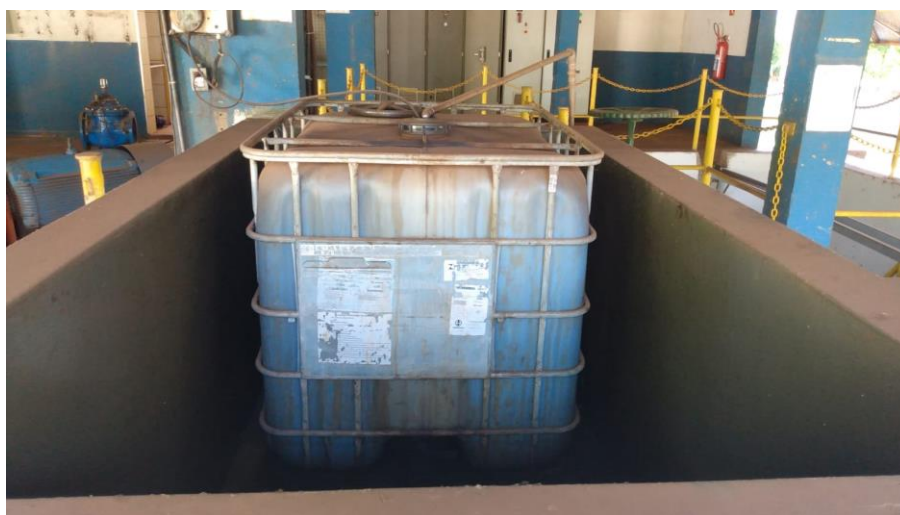
Figura 06 – Resevatório de solução de permanganato de potássio
