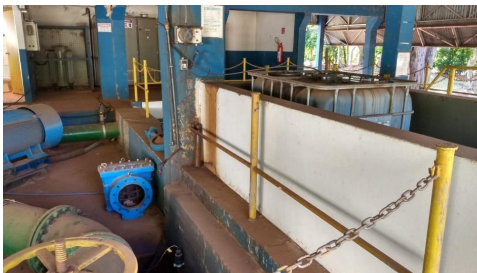
Figura 07 – Dosadora e ponto de dosagem de solução de permanganato de potássio
