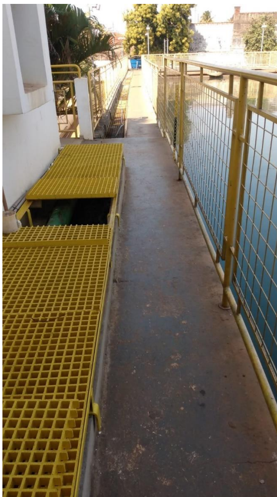
Figura 08 – Extensão da Calha Parshall
