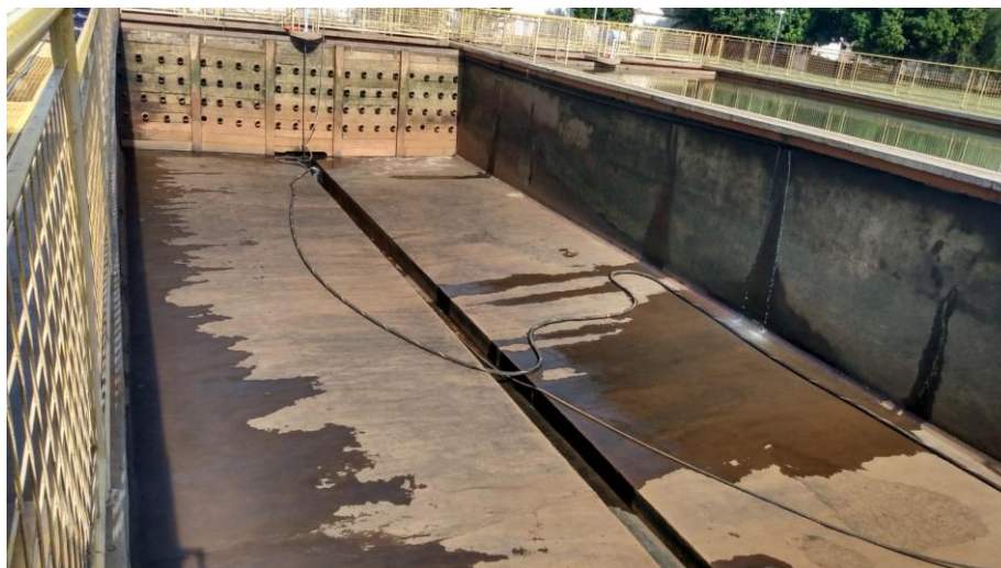
Figura 17 – Decantador vazio para processo de limpeza
