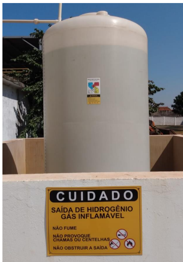
Figura 25 – Reservatório de cloro produzido na ETA
