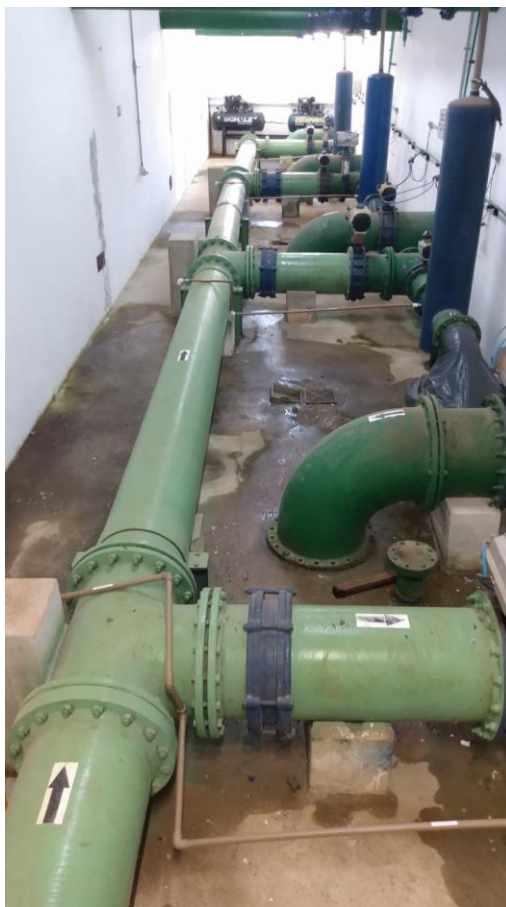
Figura 22 – Tubulação da saída da água filtrada
