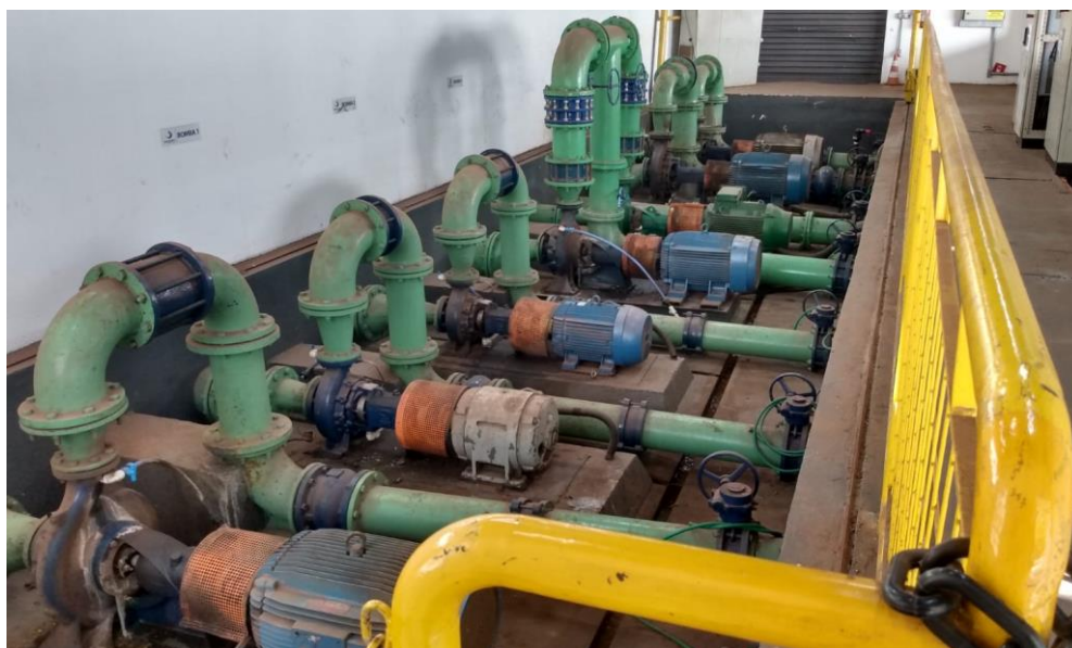
Figura 29 – Casa de bombas do sistema de bombeamento do Reservatório Quadrado
