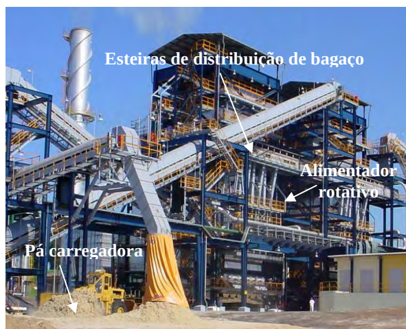
Figura 9: Foto de duas caldeiras de alta pressão 65kg/cm 2 com o sistema de alimentação de bagaço da câmara de queima de leito fluidizado e das esteiras de distribuição do bagaço operando com pá carregadora. Usina Santa Adélia. Foto Carleto 2004.
