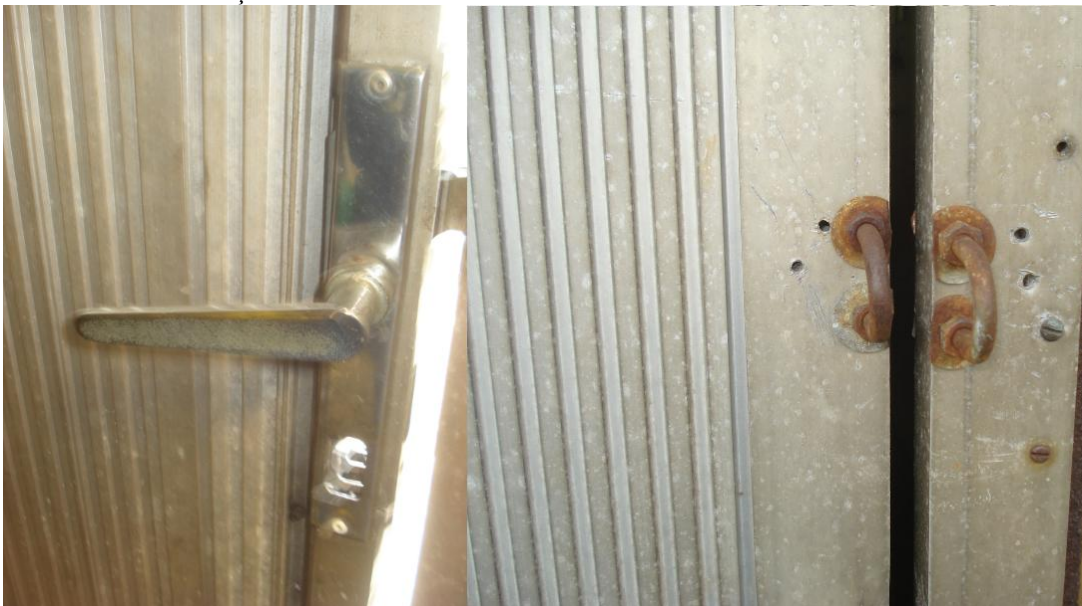
Figura 30 - Porta da subestação 18
