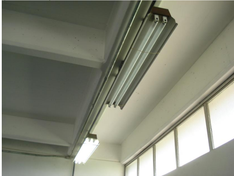
Figura 13 - Iluminação da subestação 8
