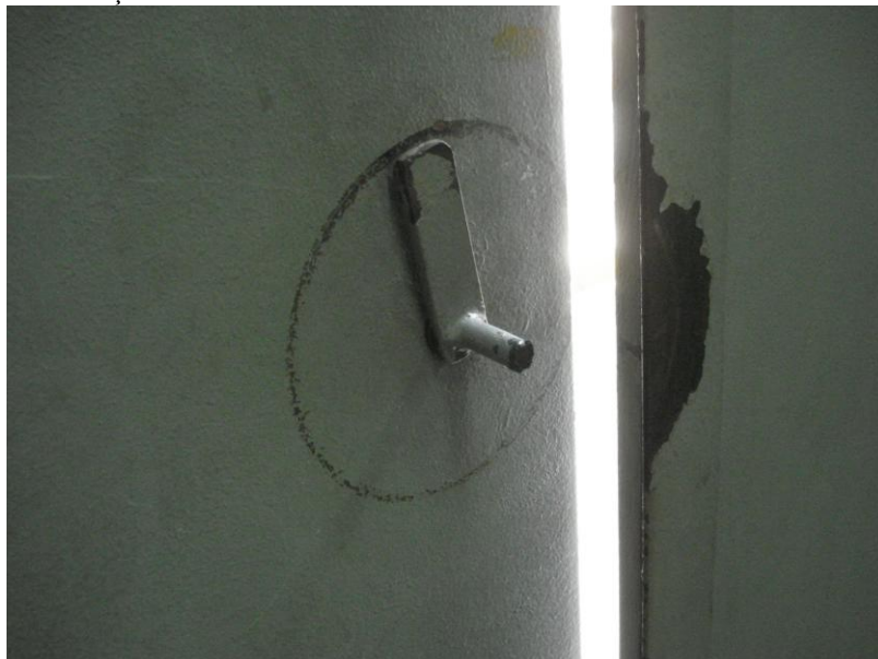
Figura 16 - Porta da subestação 11
