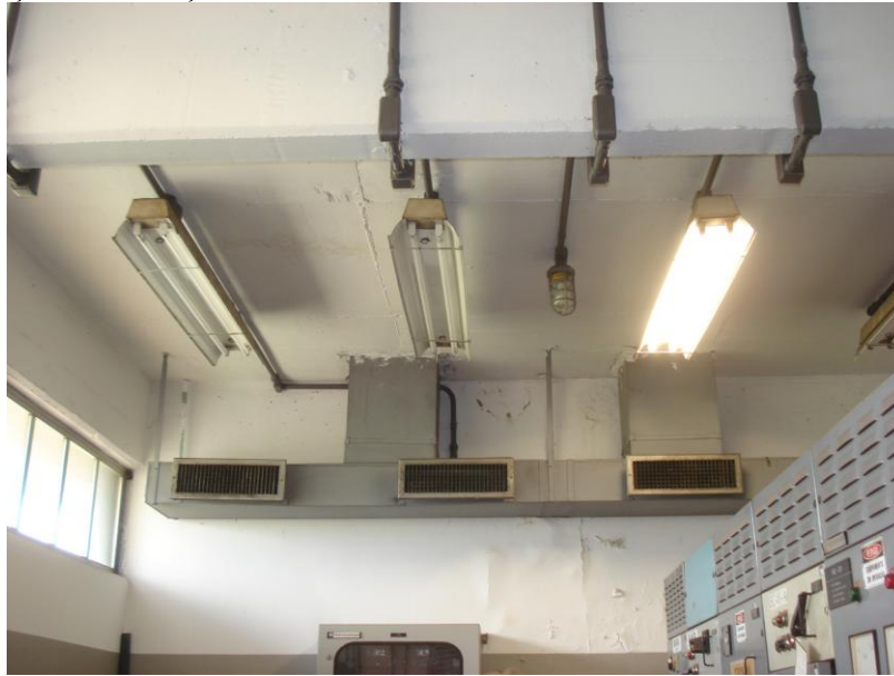
Figura 31 - Iluminação da subestação 18
