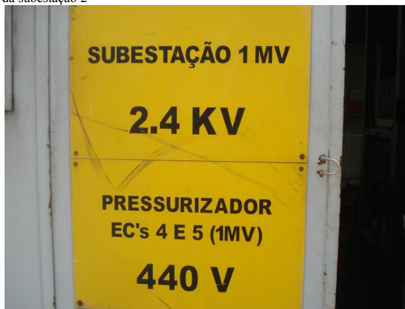
Figura 3 - Entrada da subestação 2
