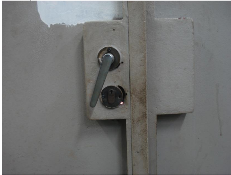
Figura 26 - Porta da subestação 16
