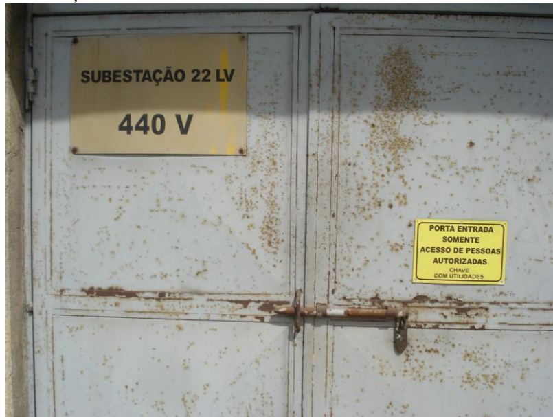
Figura 14 - Porta da subestação 9
