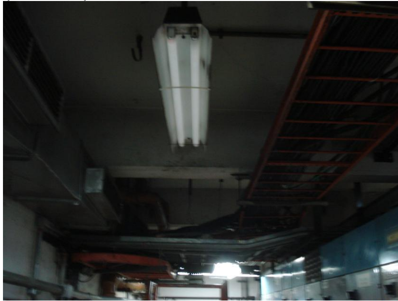
Figura 25 - Iluminação da subestação 15
