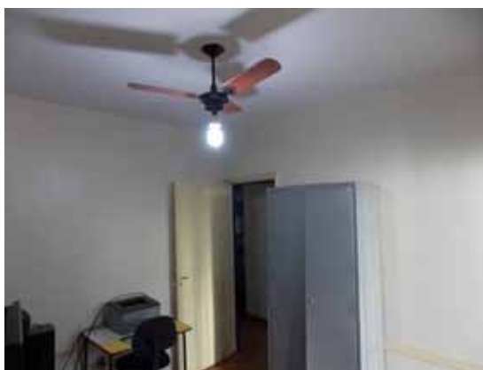
Figura 26: Iluminação artificial da sala de informática
