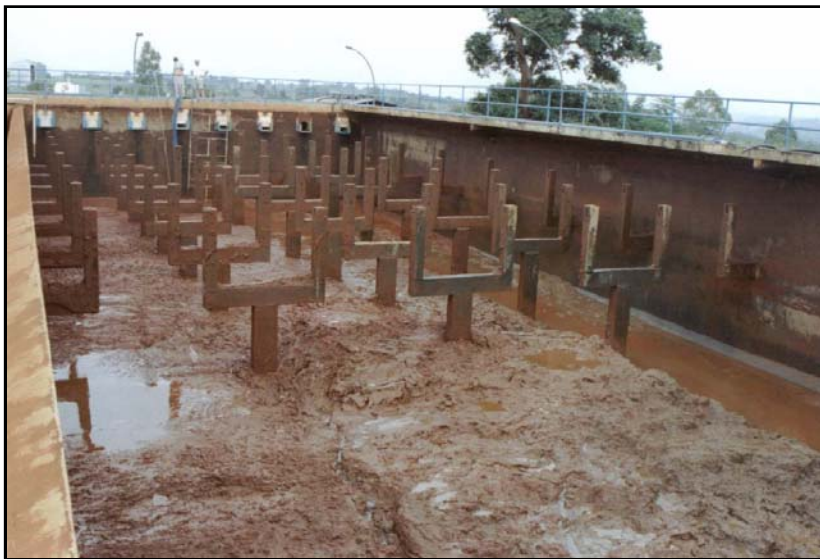
Figura 10. Unidade de decantação durante o processo de remoção do lodo, ETA II município de Rio Claro, SP.
