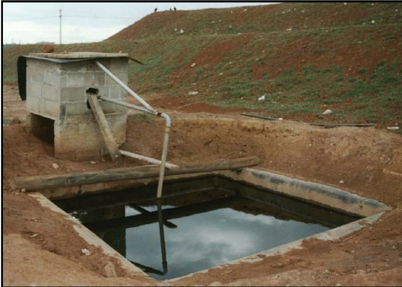
Figura 6. Poço de captação do líquido percolado no Aterro Sanitário do Município de Rio Claro, SP.
