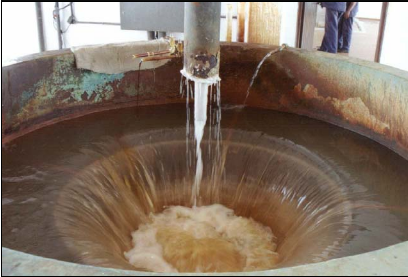
Figura 9. Câmara de mistura rápida, ETA II município de Rio Claro, SP.
