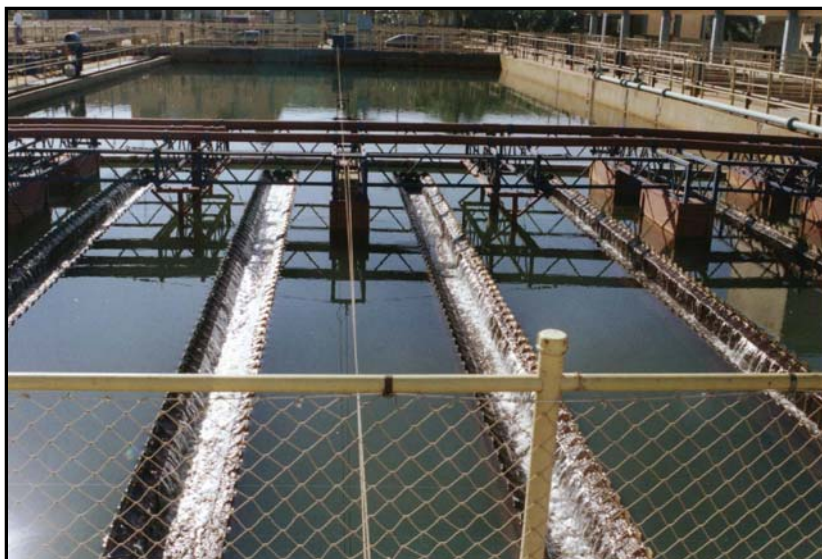
Figura 16. Unidade de decantação, ETA Capim Fino município de Piracicaba, SP.
