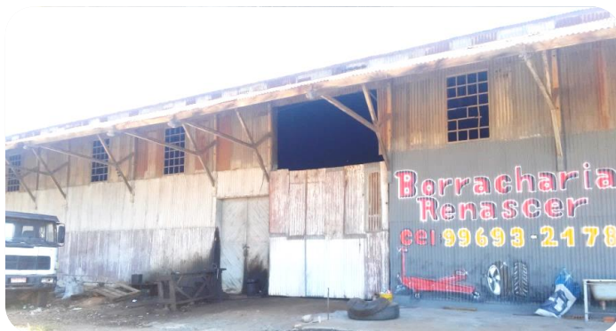
Figura 31: Aberturas inadequadas na parede externa do galpão
