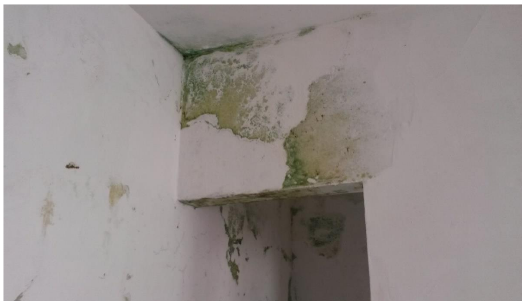
Figura 56c – Fotografia dos problemas de umidade do banheiro desativado das piscinas.
