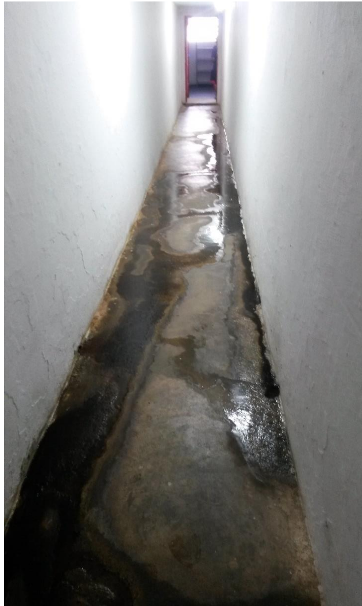
Figura 56a – Fotografia dos problemas de umidade no túnel de acesso ao campo.
