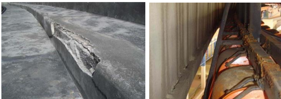
Figura 13 – Problemas de manutenção e estruturais em estádios brasileiros.
