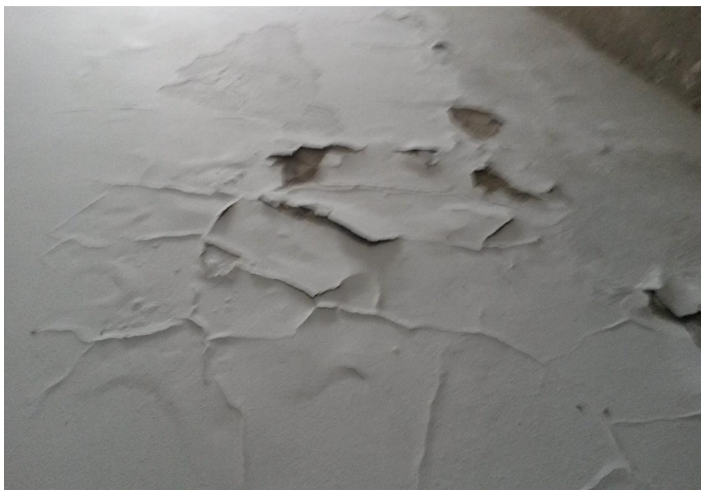
Figura 56b – Fotografia dos problemas de revestimento relacionados à falta de impermeabilização dos vestiários.
