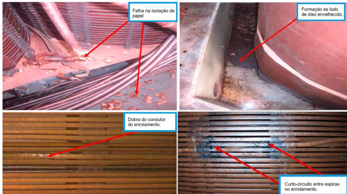
Figura 4 – Falhas no enrolamento.
