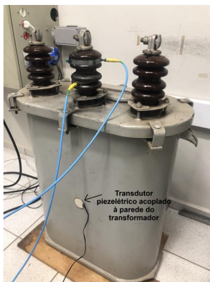
Figura 24 – Transformador de Distribuição com transdutor piezelétrico acoplado.
