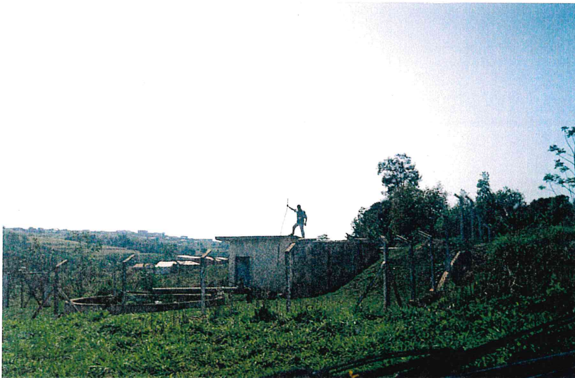
FOTO 08 - Unidade de Tratamento de Esgoto IMHOFF - Sistema "Carnascialli". Ribeirão Lindóia. Nota-se funcionário da SANEPAR desobstruindo encanamento rompido. Foto do Autor
