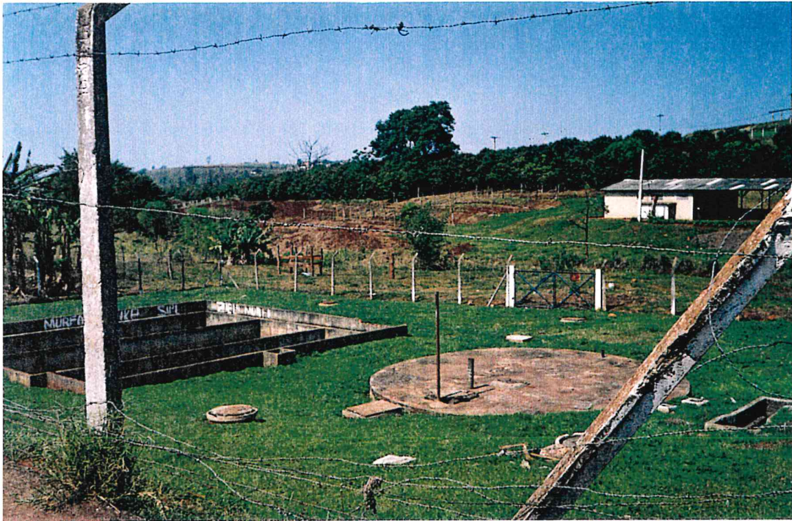
FOTO 09 - Aspecto da Unidade de Tratamento de Esgoto IMHOFF - Sistema "Violin". Córrego Cabrinha. Foto do Autor
