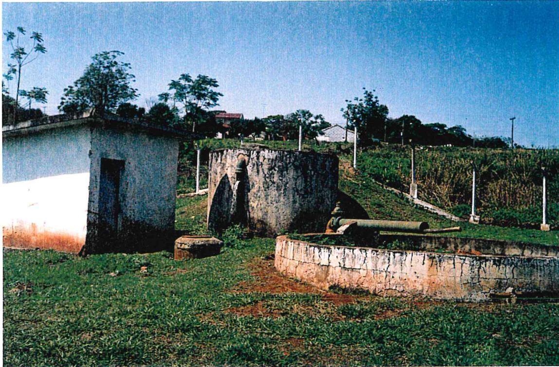
FOTO 07 - Unidade de Tratamento de Esgoto - IMHOFF - Sistema "Carnascialli" - Ribeirão Lindóia. Nota-se cano danificado por atos vandalistas. Foto do Autor
