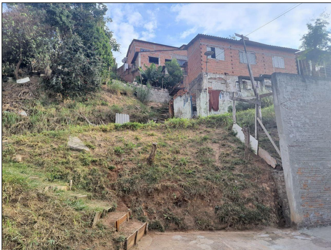
Figura 47 – Taludes com cortes verticais.
