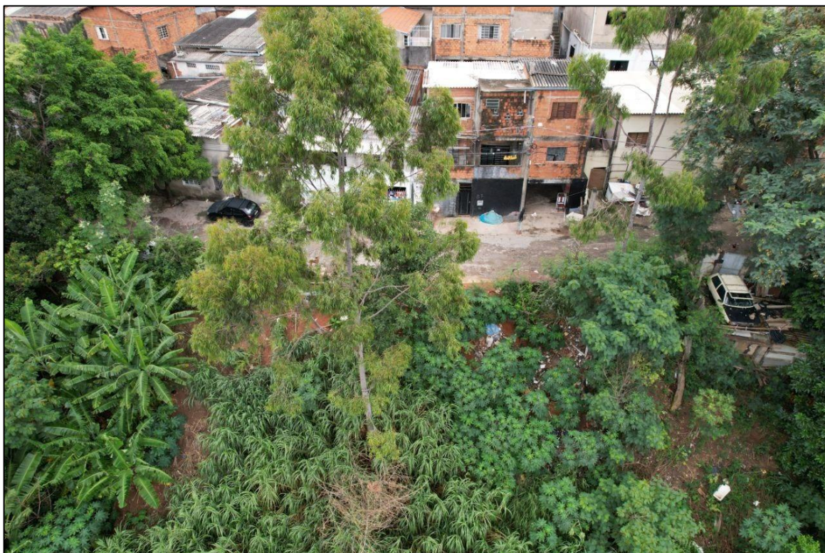
Figura 54 – Topo do talude com erosão ativa, bananeiras, descarte de resíduos sólidos e carro estacionado.
