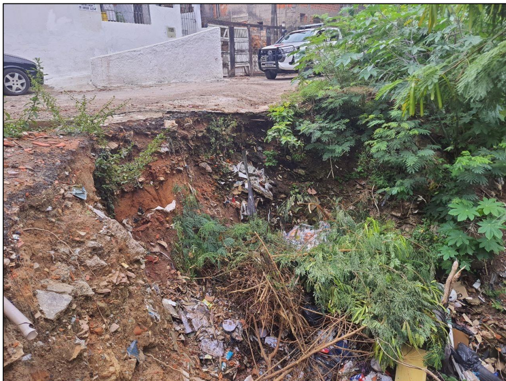
Figura 52 – Erosão ativa com acúmulo de resíduos sólidos.
