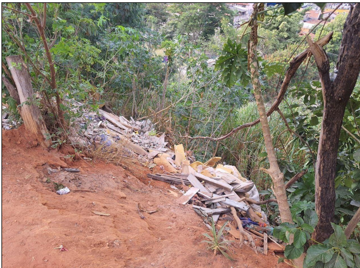
Figura 48 – Resíduos sólidos e de construção civil presentes próximo ao topo do talude.
