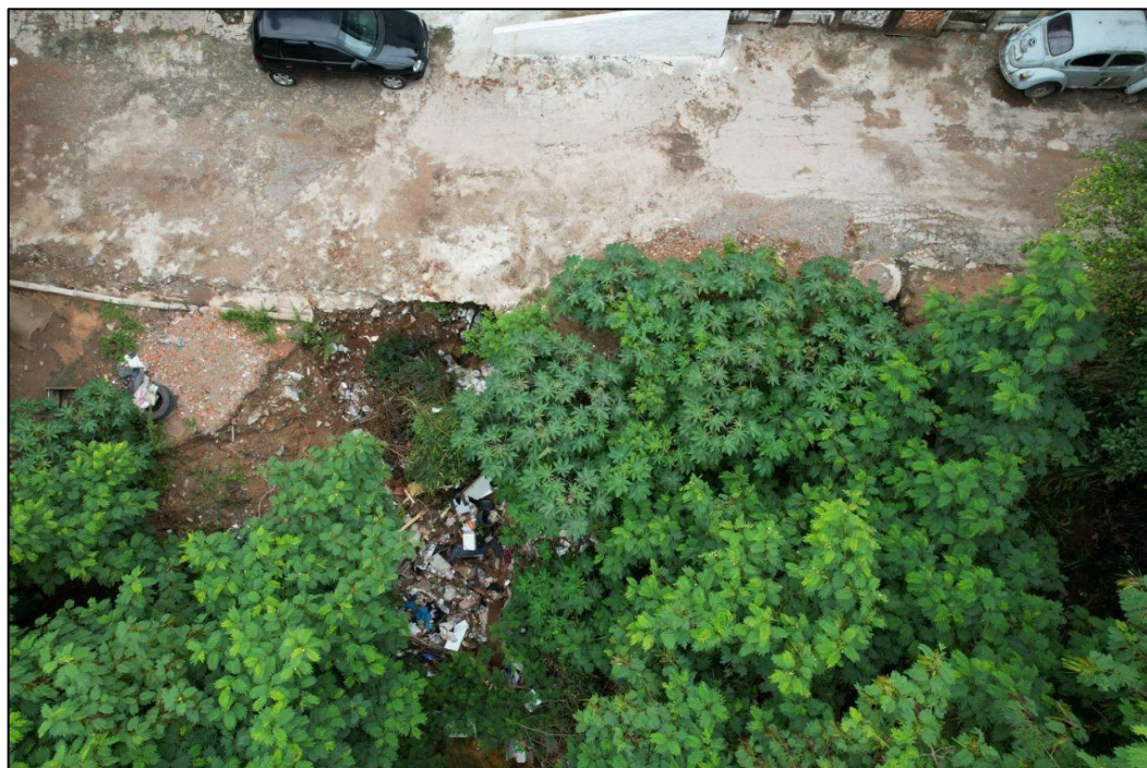
Figura 50 – Erosão ativa no topo do talude atingindo a via pública e descarte de resíduos sólidos.
