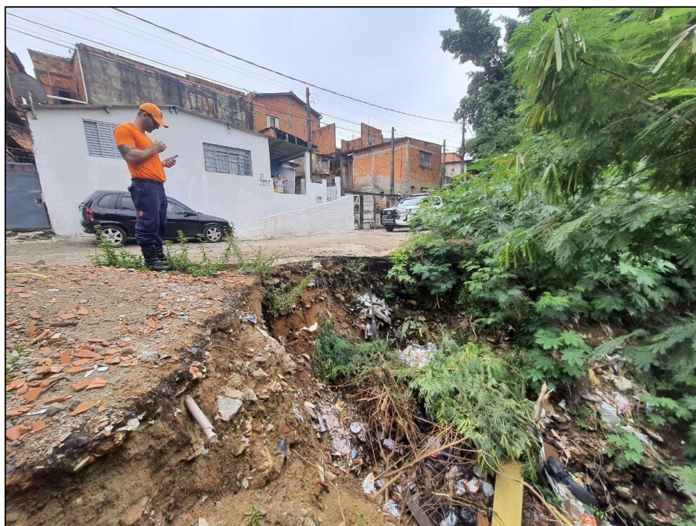
Figura 53 – Agente de Defesa Civil realizando o registro da erosão para encaminhamento à Secretaria de Serviços Públicos.
