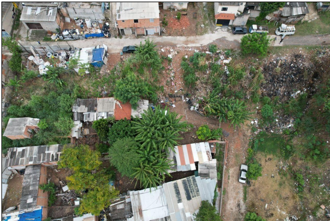
Figura 58 – Resíduos sólidos e materiais de reciclagem no topo do talude com erosão ativa.
