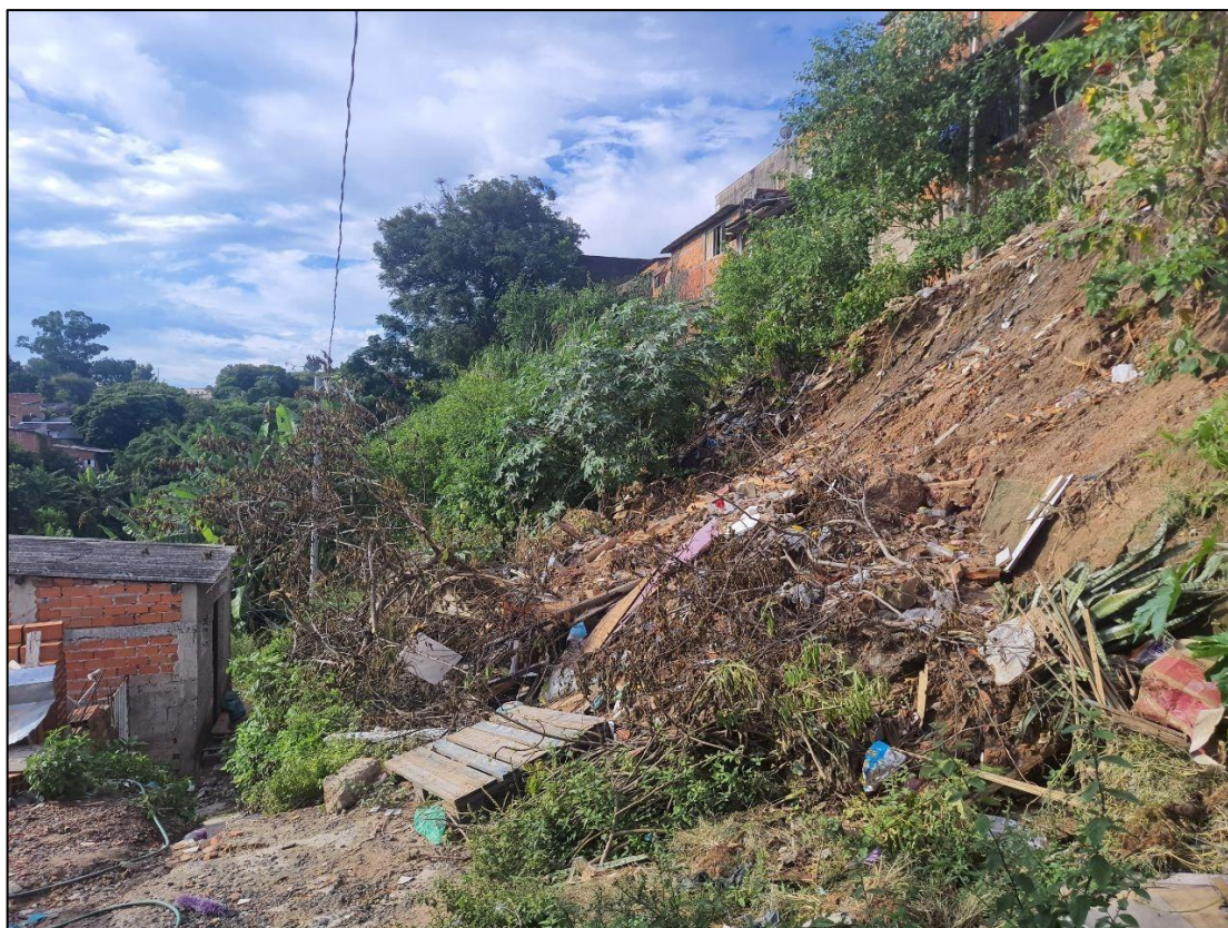
Figura 59 – Talude exposto e com acúmulo de resíduos sólidos.
