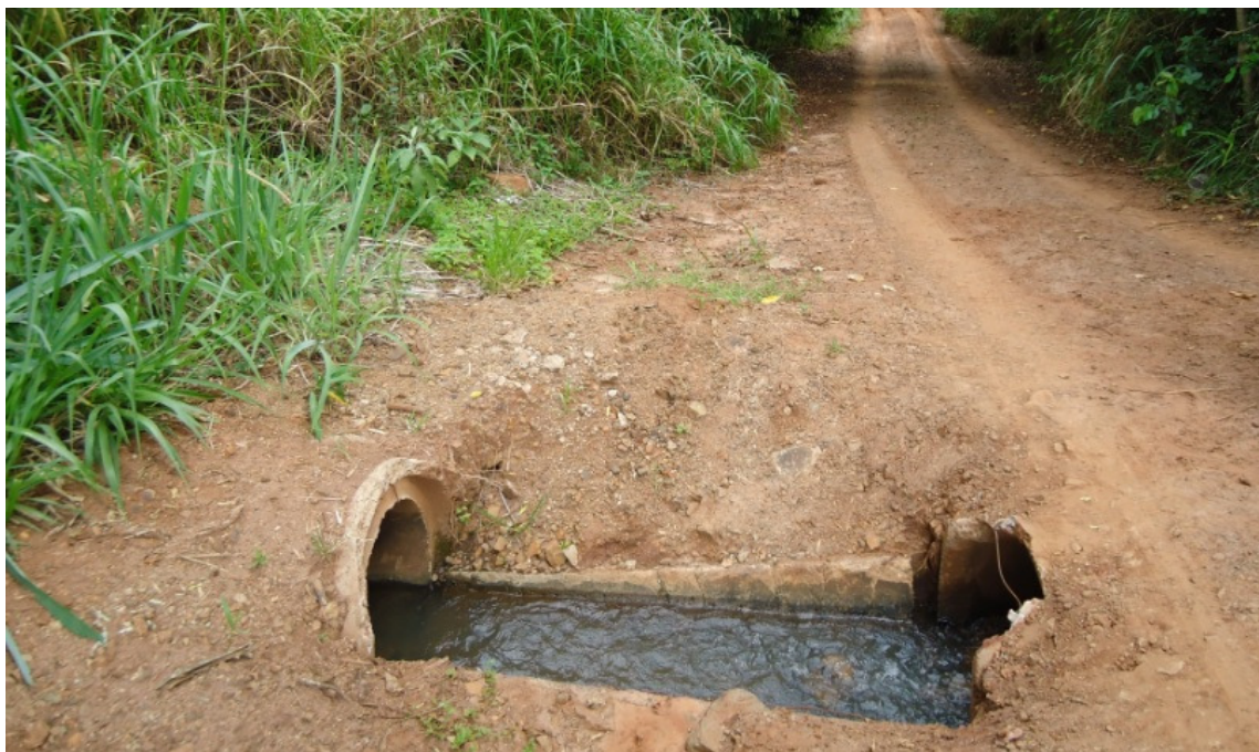
Figura 24 - Canalização quebrada no córrego Barra Seca.
