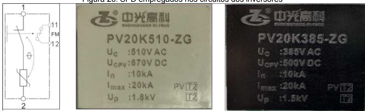
Figura 26: SPD empregados nos circuitos dos inversores
