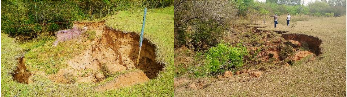
Figura 11 - Processos erosivos nas margens do córrego, sendo possível observar os horizontes dos Argissolos Vermelho-Amarelo.
