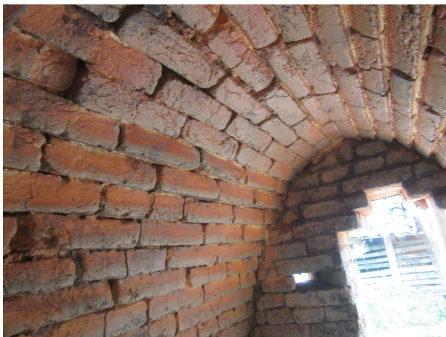
Figura 84: Vista da integridade das paredes do forno após segunda queima. Resende Costa, 2016.
