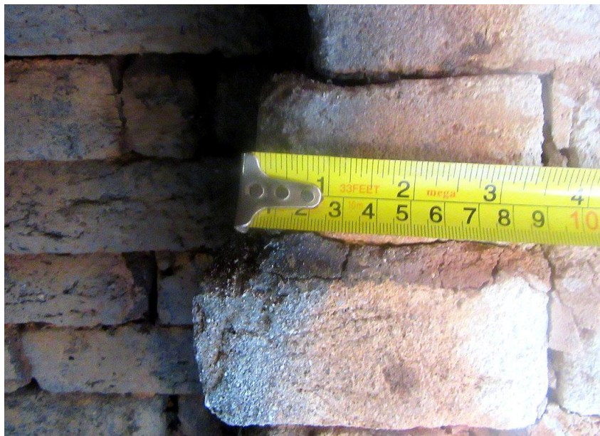
Figura 50: Amostra de área de tijolo mais atacada pelo calor. Resende Costa – MG, 2016.
