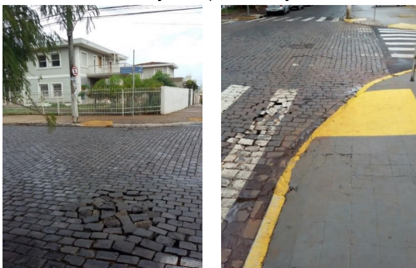
FIGURAS 20 e 21: Trechos degradados da pavimentação tombada da Avenida Nove de Julho. FONTE: Os autores, 2016.
