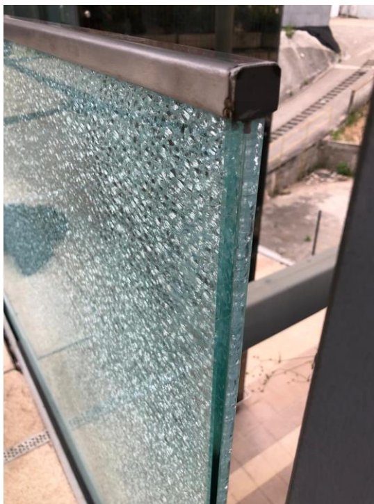
Figura 3 – Quebra do vidro laminado
