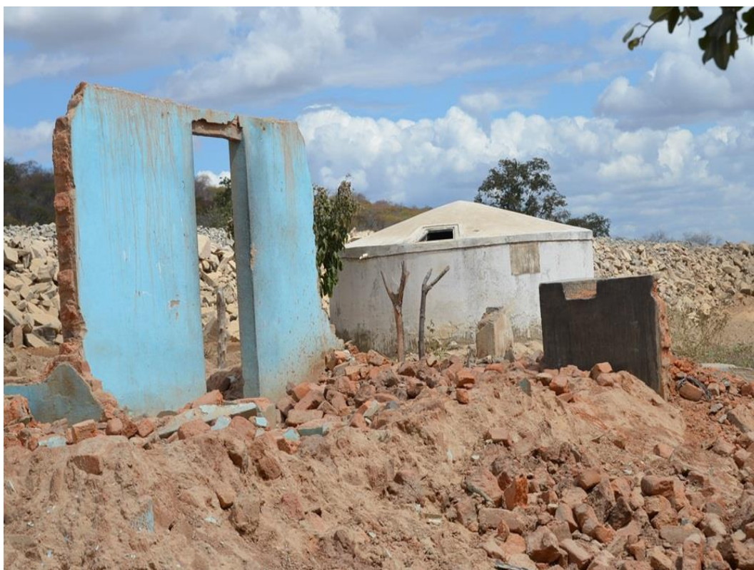
Figura 4 — Moradia e cisternas demolidas pela Ferrovia Transnordestina
