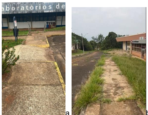
Figura 30 - Faces de calçada com baixa manutenção – F121A e F211A de Bauru
