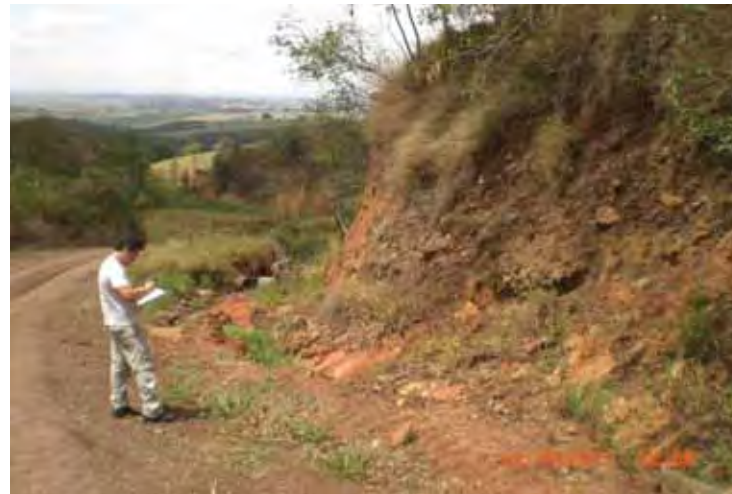
Foto 17. Talude expondo depósito tálus, com blocos soltos e rolados na margem da estrada (CHQ-040). (Unidade 4, ponto 5)
