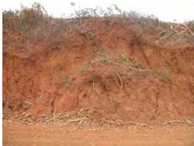
Foto 6. Talude de 2,5m exibindo Instabilização de massa (escorregamento) devido à alta inclinação. (Ponto 16)
