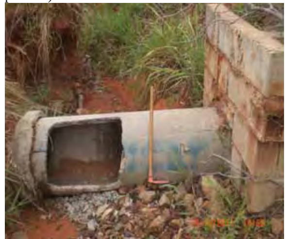
Foto 19. Sistema de canalização de água danificado. (Unidade 4, ponto 5)
