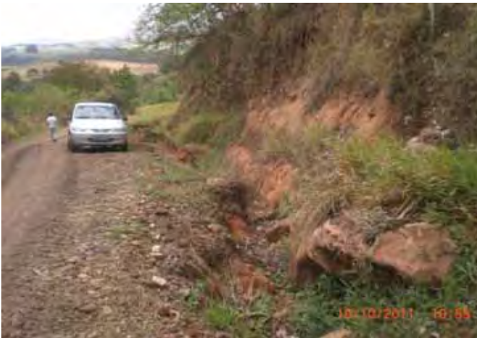
Foto 16. Blocos de diferentes tamanhos (até métricos) rolados e erosão na canaleta de drenagem da estrada (CHQ-040). (Unidade 4, ponto 5)
