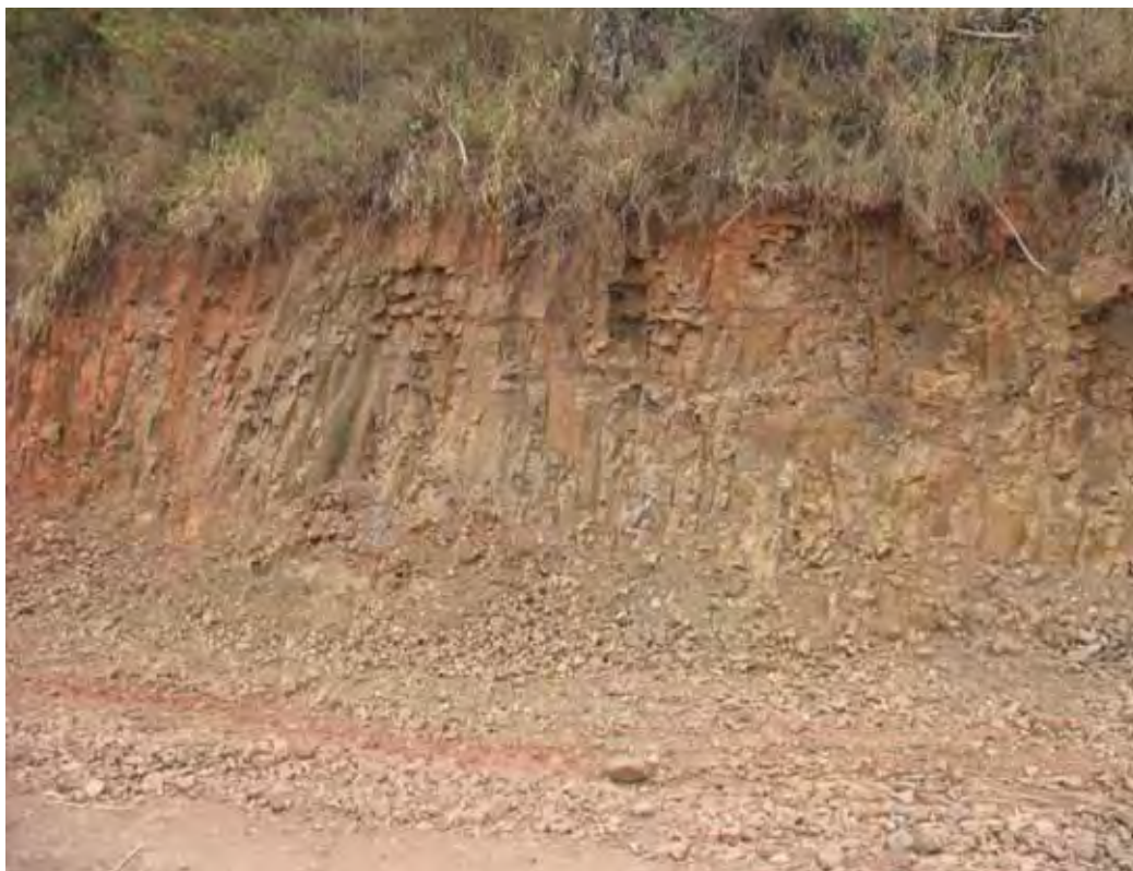
Foto 10. Talude de corte na estrada (CHQ-040), demonstrando basalto bastante fragmentado e micro-fraturado (disjunção colunar), com muitos blocos susceptíveis a queda e espalhados pela estrada. (ponto 18)
