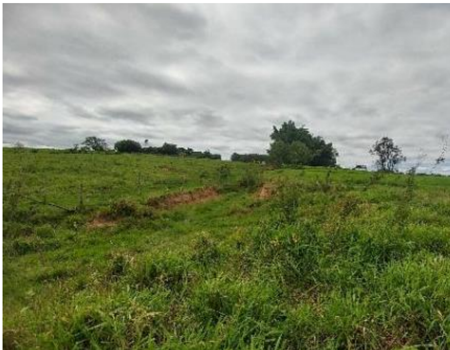
Figura 25 - Sulco erosivo registrado por Lima (2018) a Leste da Parcela 6, junto à Microunidade 2-B.
