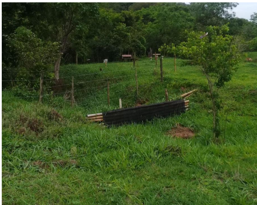
Figura 26 - Situação atual da erosão presente no limite Leste da Parcela 6, junto à Microunidade 2-B.
