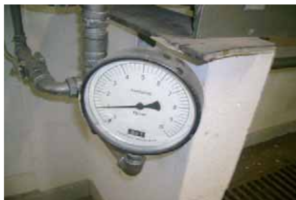
Figura 46 - Detalhe do indicador de pressão = 0,1 MPa
