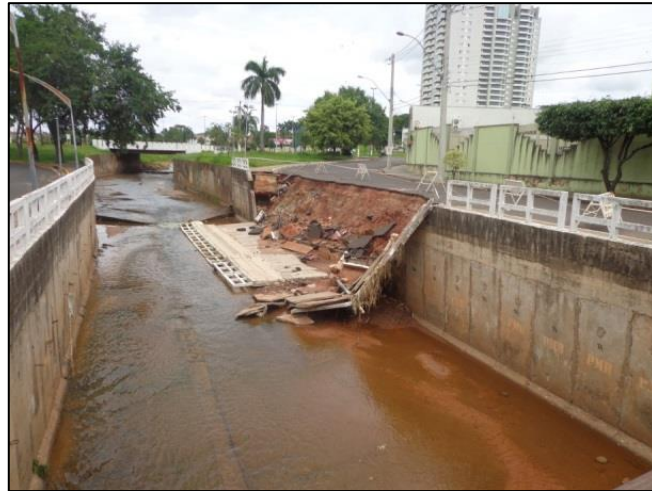
Figura 23 - Queda de margem – Córrego Biriguizinho. Foto: Alessandra Fagundes (2017).
