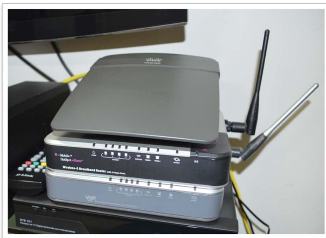
Figura 25 - Set top box Dlink Totvs, roteadores e NAS de armazenamento em rede
