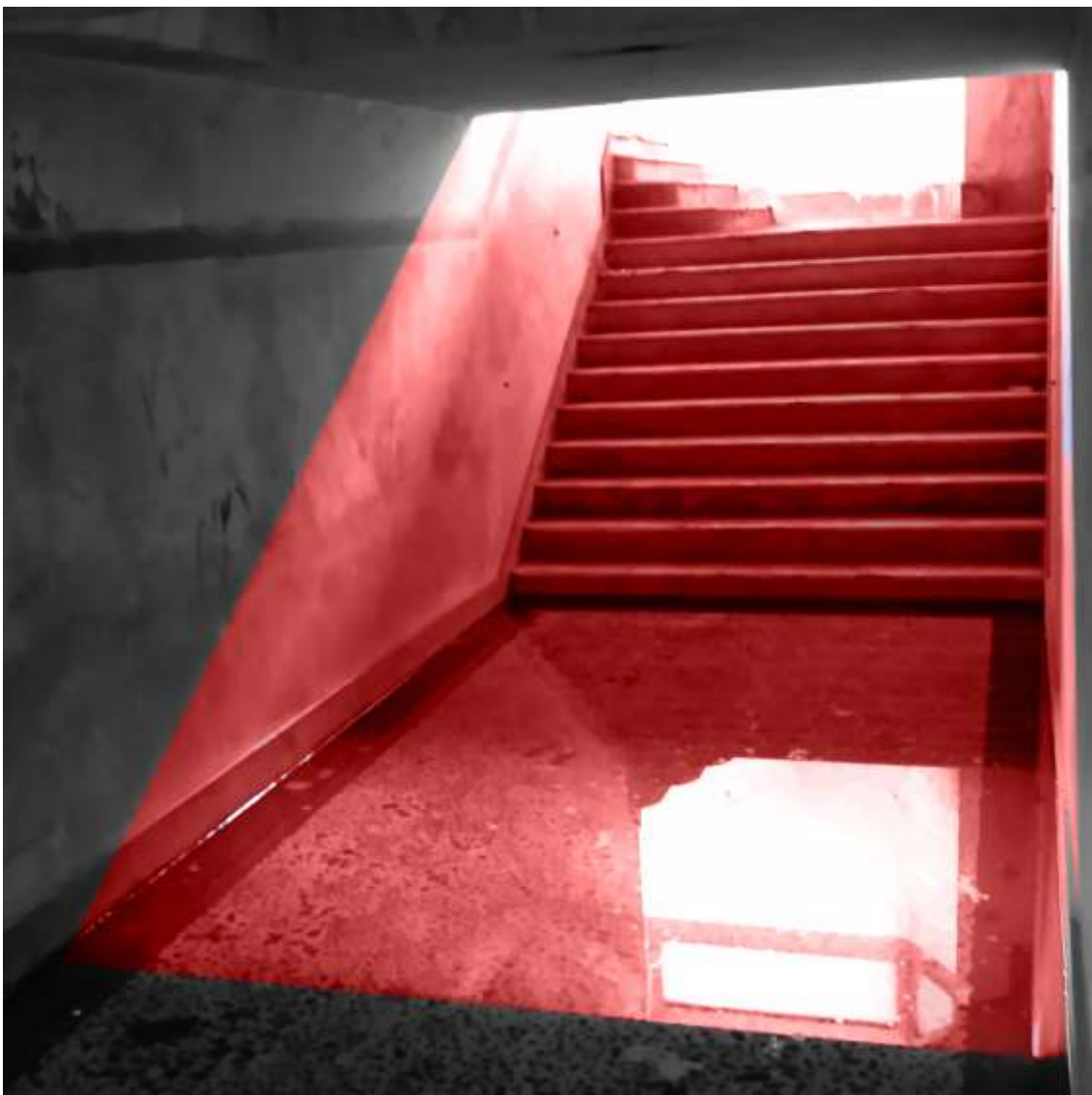
Figura 17 – Passagem sob os trilhos alagada
