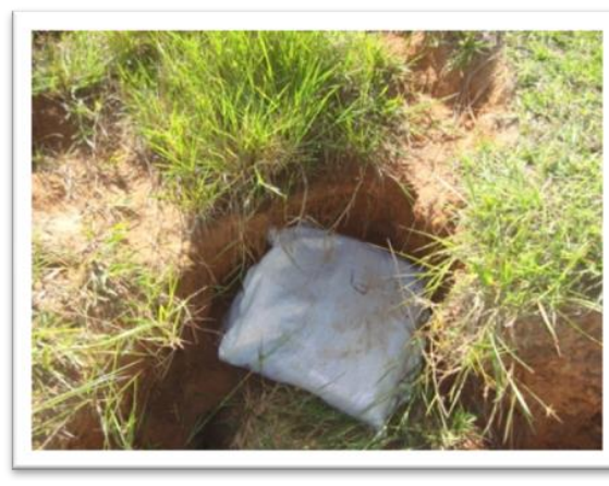
Figura 56. Disposição dos sacos de ráfia na alcova de regressão provocada pelo escoamento superficial a montante da barreira de contenção na erosão 2. Fonte: Autores (março de 2012)
