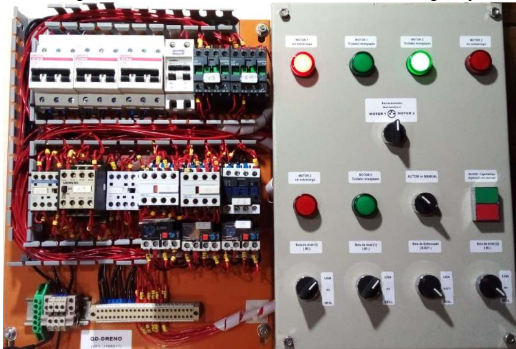
Figura 49: Modo revezamento com a bomba 1 em sobrecarga no painel
