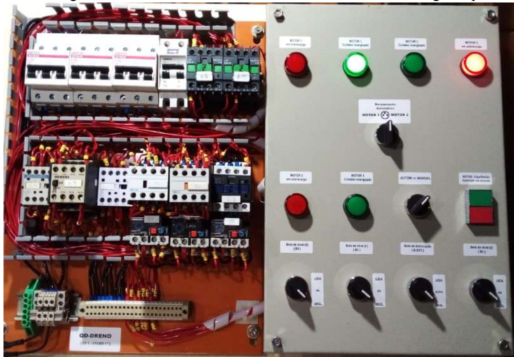
Figura 48: Modo revezamento com a bomba 2 em sobrecarga no painel
