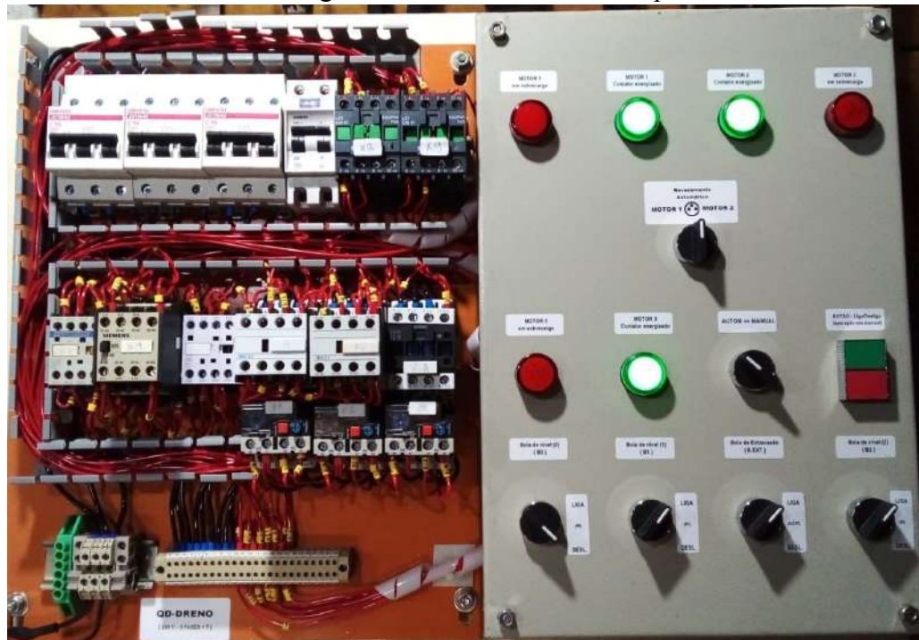
Figura 45: Falha da boia b0 no painel
