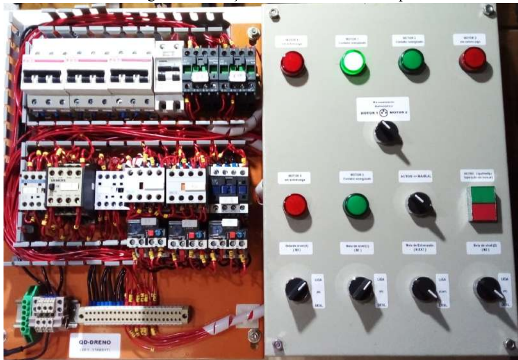
Figura 42: Seleção do modo bomba 1 no painel
