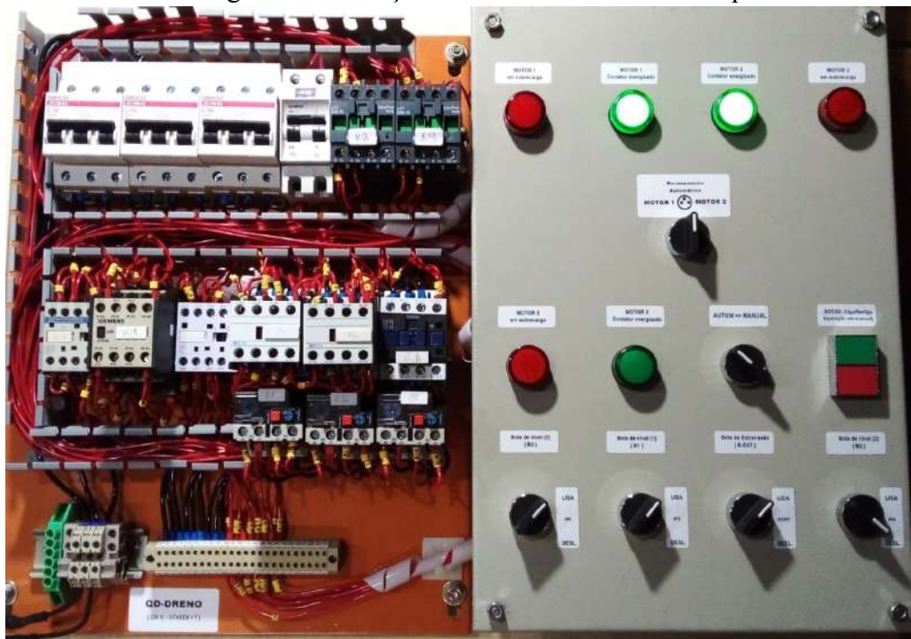
Figura 44: Ativação da boia de extravasão no quadro
