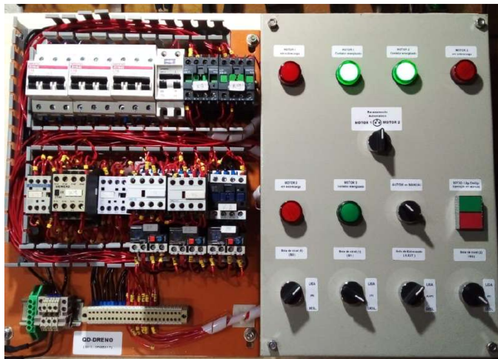
Figura 46: Falha da boia b1 no painel
