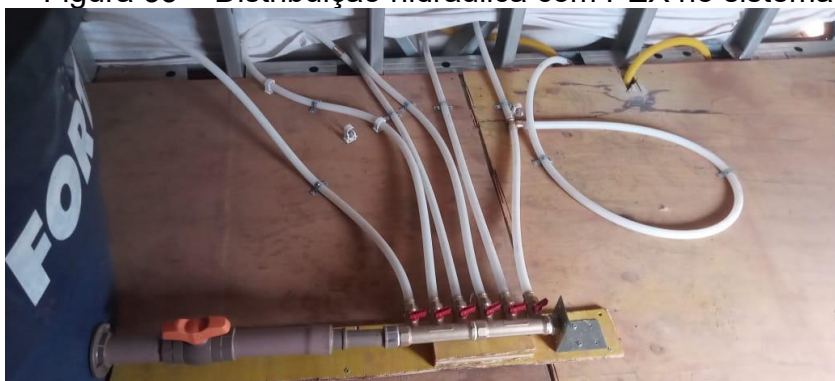
Figura 33 – Distribuição hidráulica com PEX no sistema LSF
