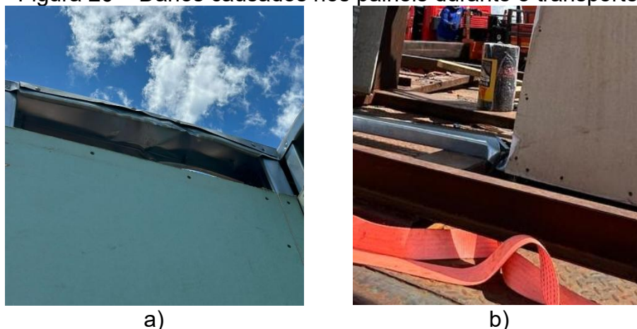
Figura 26 – Danos causados nos painéis durante o transporte
