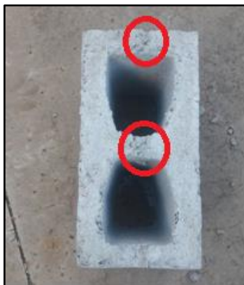
Figura 2 - Bloco vazado de concreto com superfície irregular
