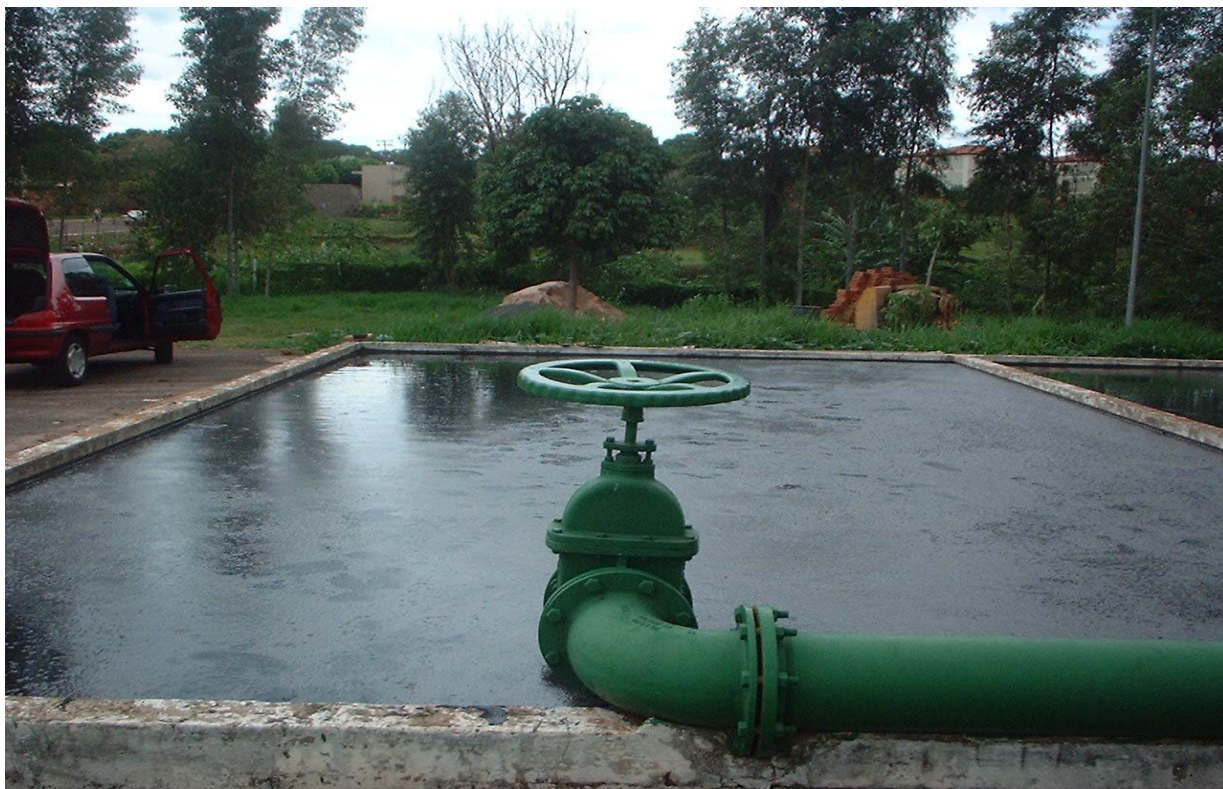
Figura 3 – Lodo líquido depositado na caixa de decantação após permanência no Reator Anaeróbio de Lodo Fluidizado
