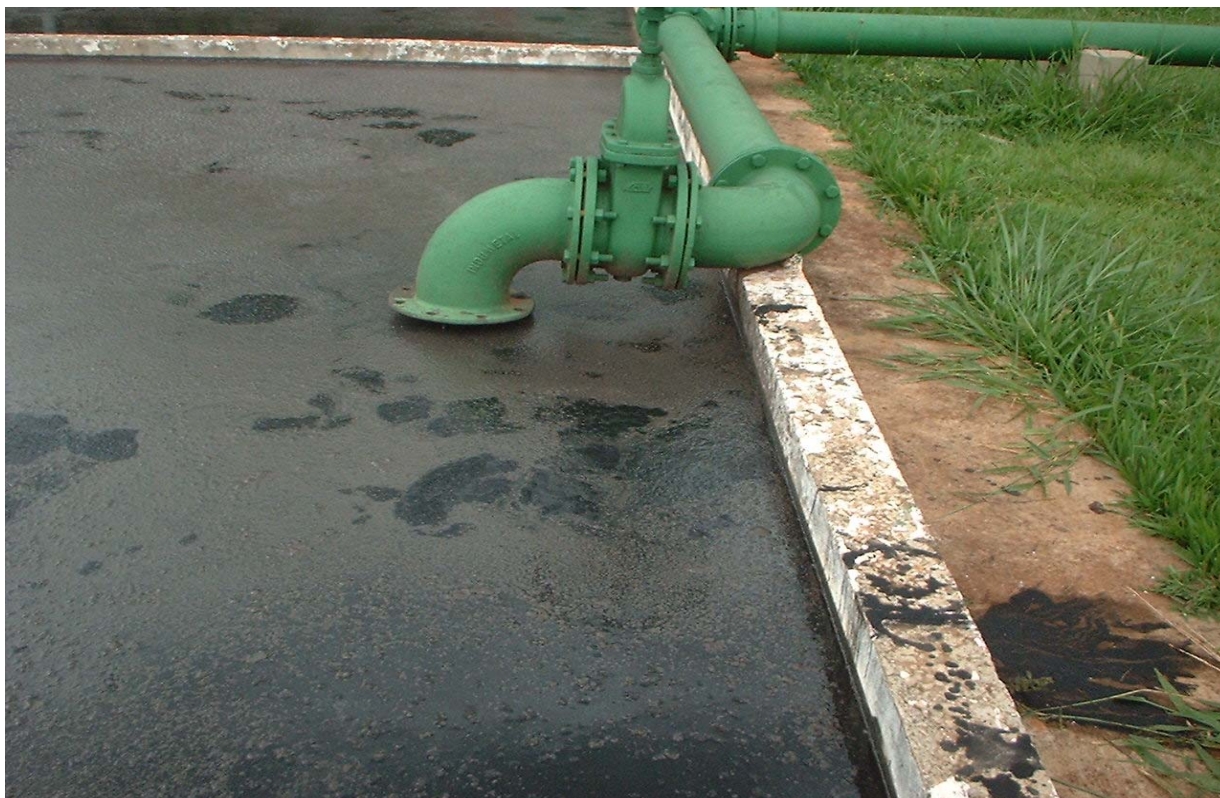
Figura 4 – Caixa de decantação de lodo líquido após permanência no Reator Anaeróbio de Lodo Fluidizado (RALF)
